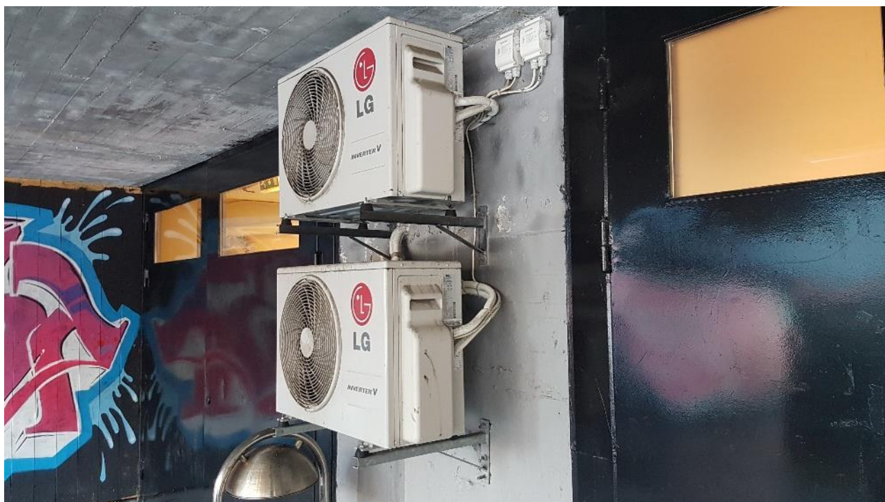
Figur 8: Eksempelbilde av varmepumper som skal demonteres dersom opsjonen utløses
