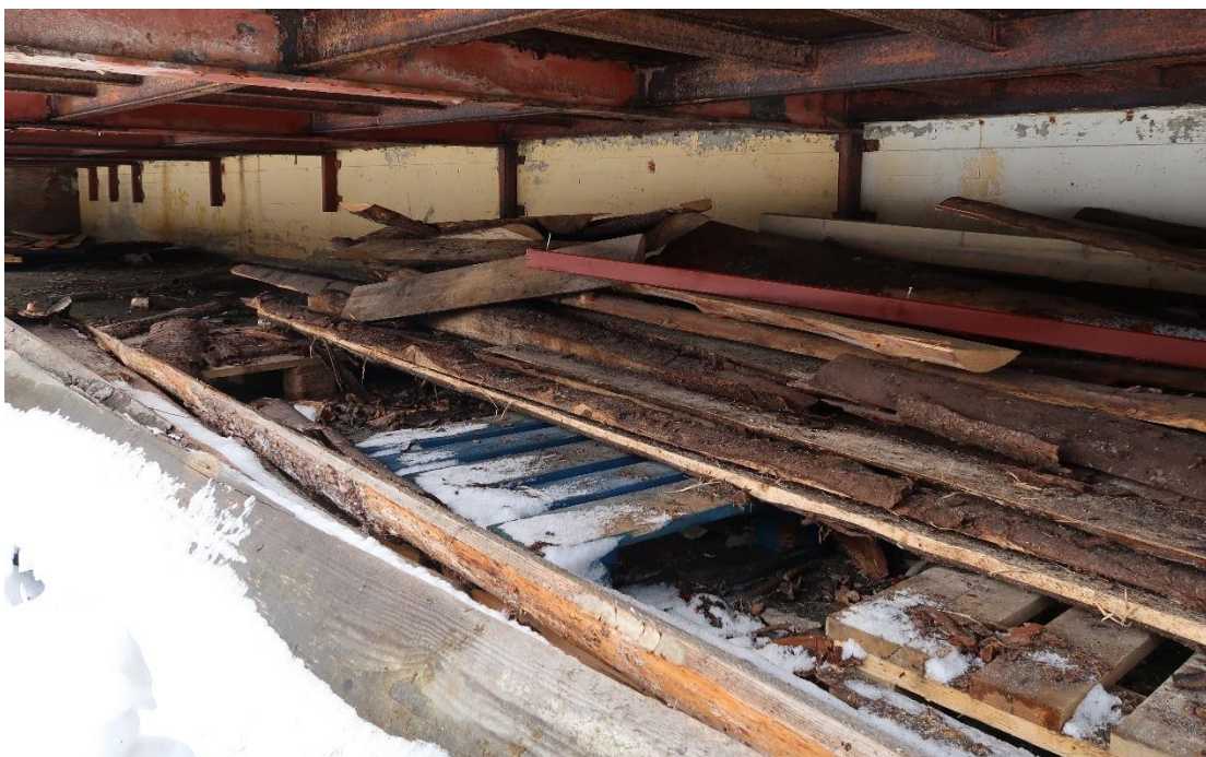
Figur 5: Bilde av forholdene under rampen på utsiden av og over ventilasjonsrom for aggregat 360.02. Ventilasjonsrommet ligger innenfor veggen vist på bildet.
