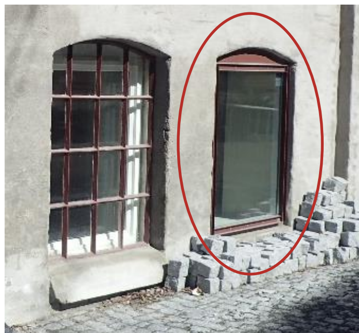
Bilde 8 viser vindu på sørfasde (markert med rød sirkel) som skal byttes med kopi av originalvindu
