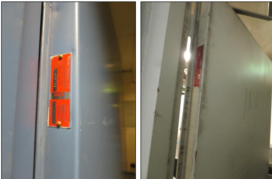
Figur 10: Eksempler på ulike branndører i bygget.
