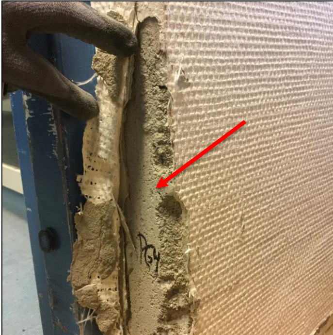
Figur 36: Prøve 4 av pusslag på vegg i en korridor i 3. etasje.
