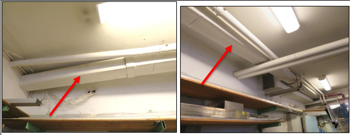
Figur 18 Bildene viser eksempel på eternitkanaler i bygget ; i himling i verkstedet i 1. etasje.
