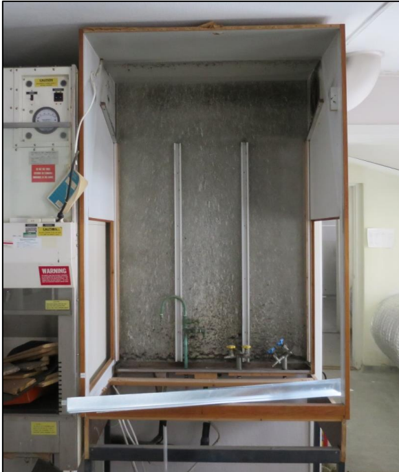
Figur 16: Avtrekkskap hvor bakenforliggende plate er eternitplate.
