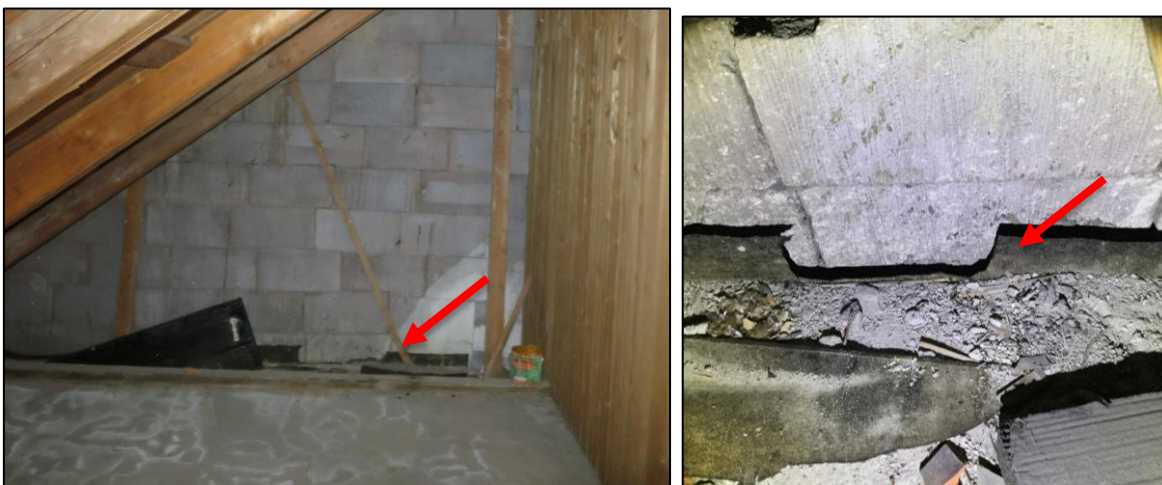
Figur 32: Takpapp/asfaltbelegg på takterrasse og 4. etg loft.
