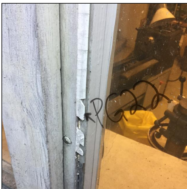
Figur 8: Vinduskitt på koblede vinduer i 1. etasje/kjeller inneholder ikke asbest.
