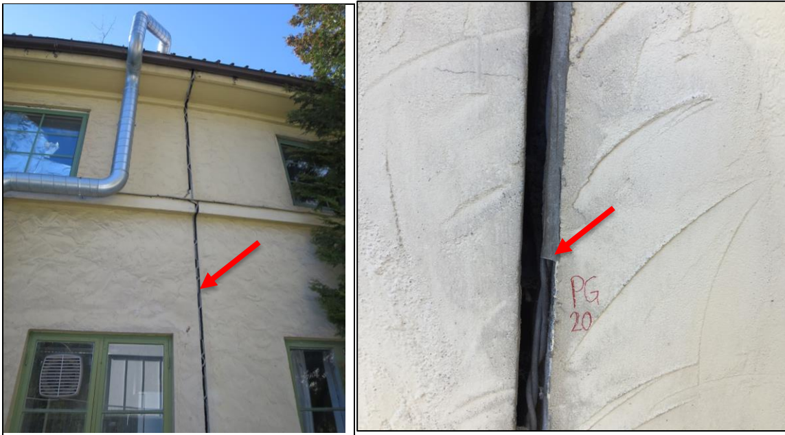
Figur 22 Grå fuge på fasaden er ordinært avfall, prøve 20.
