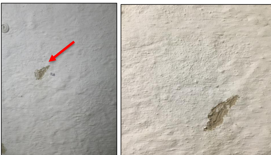
Figur 40: Prøve 16 av pusslag og maling på betongvegg i kapell i 2. etasje.
