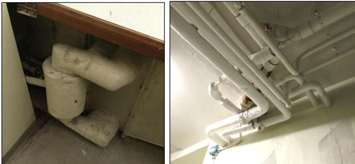
Figur 19: Eksempler på opprinnelige rørføringer og rørbend med isolasjon i Bygg G.
