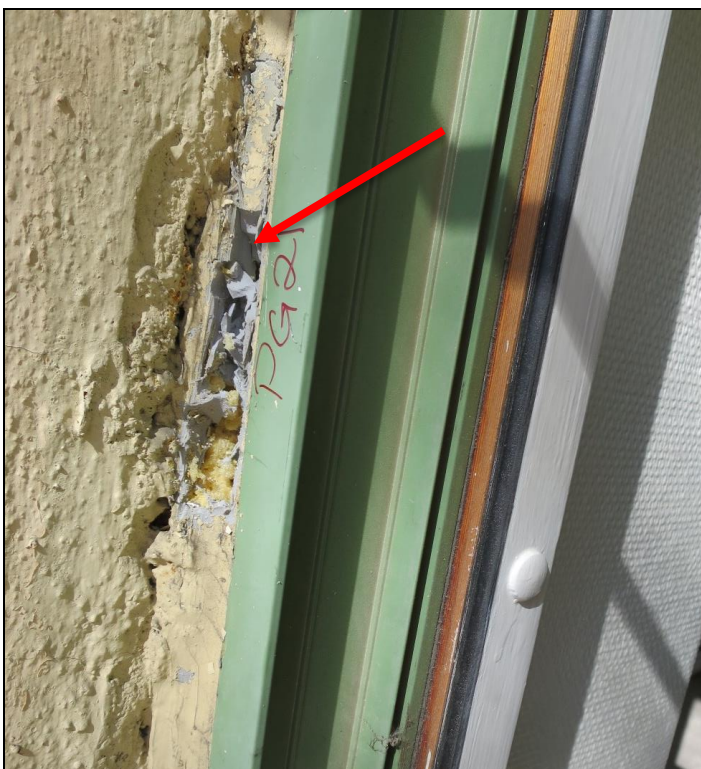
Figur 23 Grå fuge mellom vindu og vegg, prøve 21.
