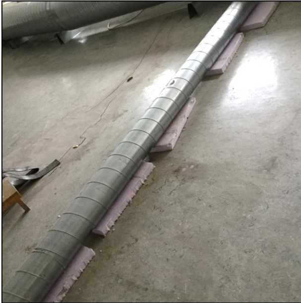
Figur 27: EPS isolasjon under rør håndteres som farlig avfall.
