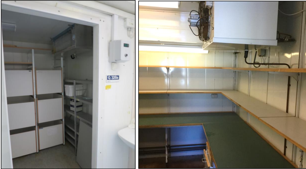
Figur 29: Eksempler på kjølerom i 4. etasje (til venstre) og 2. etasje (til høyre) i Bygg G.
