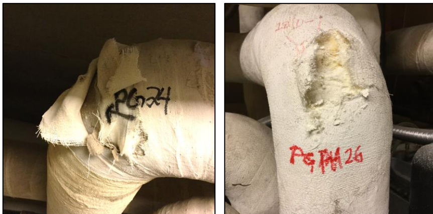
Figur 20: Prøver 24 og 26 avkrefter innhold av asbest.
