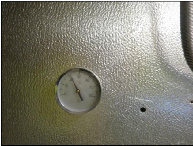
Figur 34: Målere på rør i ventilasjonsrom i 4. etasje.
