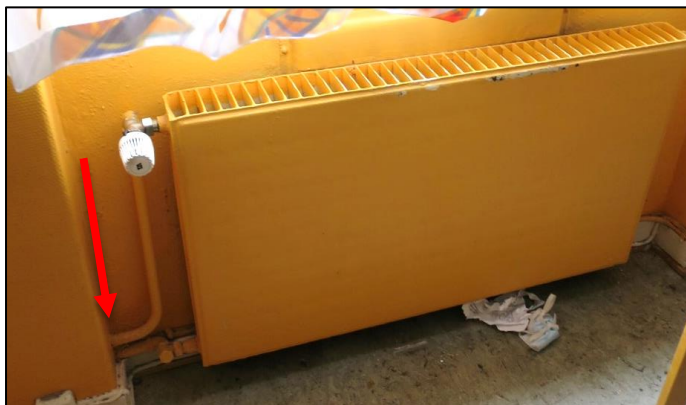
Figur 9: Rørgjennomføringer i dekke ved radiator. Rørgjennomføringer kan inneholde asbest.
