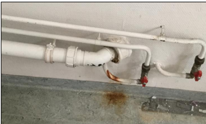
Figur 31: Blyskjøter i korridor i 3. etasje.
