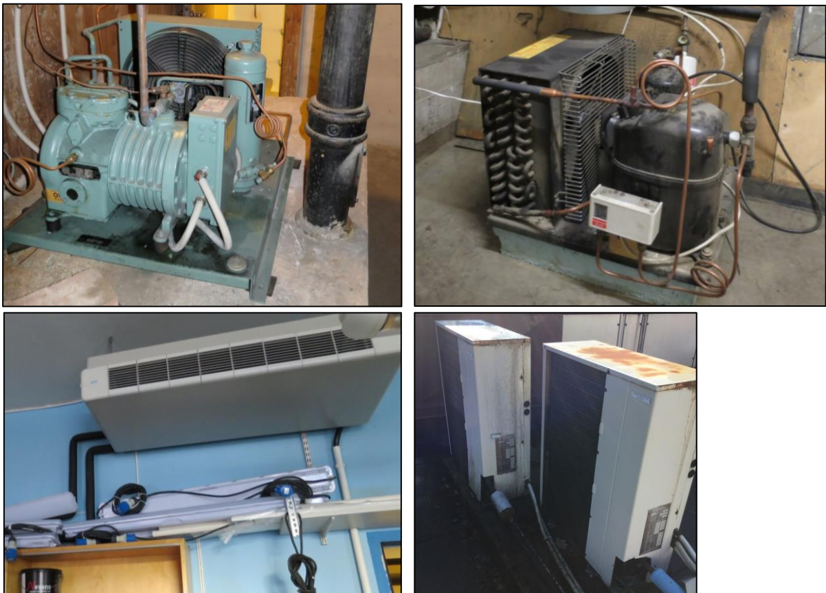
Figur 33: Eksempler på kjølemaskiner i Bygg G.
