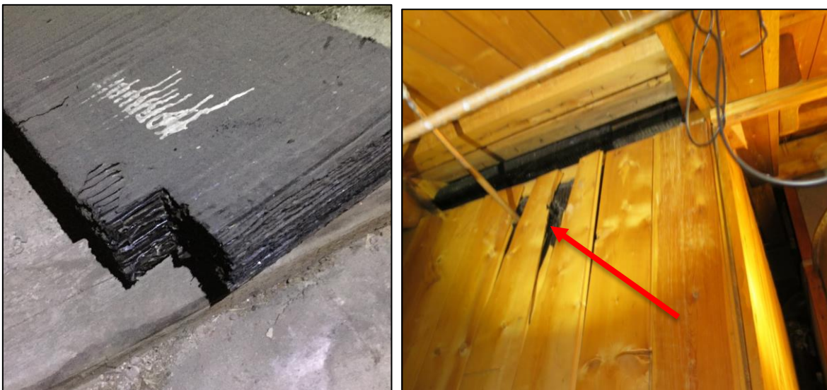
Figur 11: Isolasjonsmateriale mellom vegg inneholder asbest.
