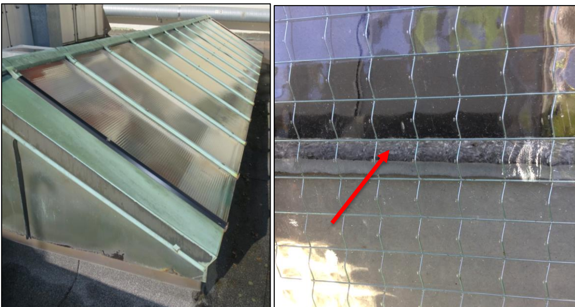
Figur 17: Til venstre, takvinduer observert på taket av bygnigne. Til høyre, grå utføringsplater inn i takvinduet som kan inneholde asbest.
