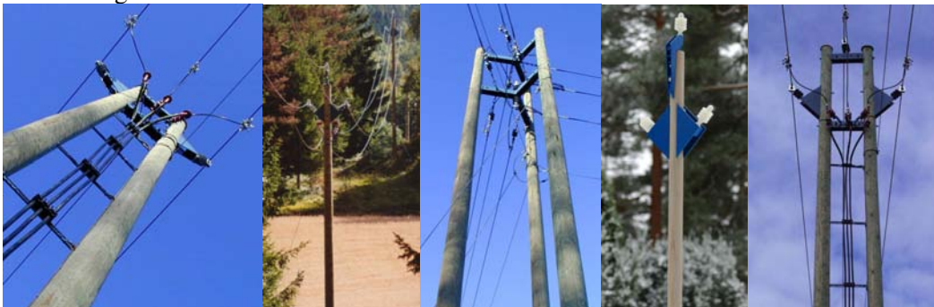
22 kV master, Grunnformer gir familielikhhet ved å gjentas på master med ulik funksjon, Widenoja og Hemstad, 2001, EBL
