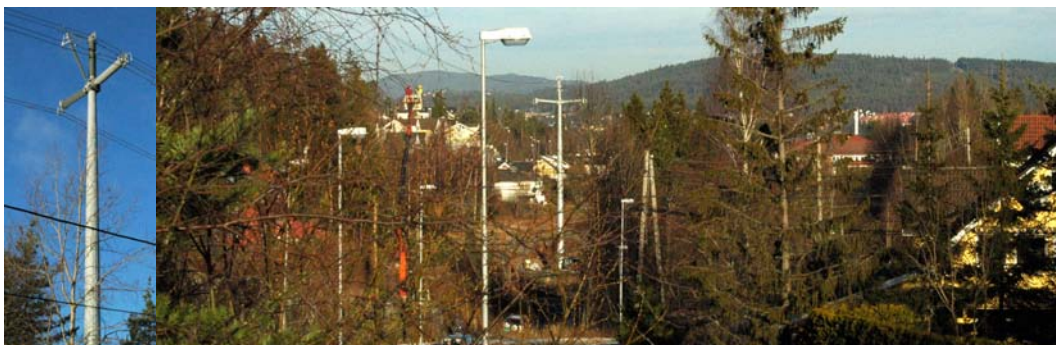
Fra "Miljøprosjekt på Rasta" hvor Statnett tester en ny 300 kV mast for å redusere miljøpåvirkning i tettbebygde strøk
