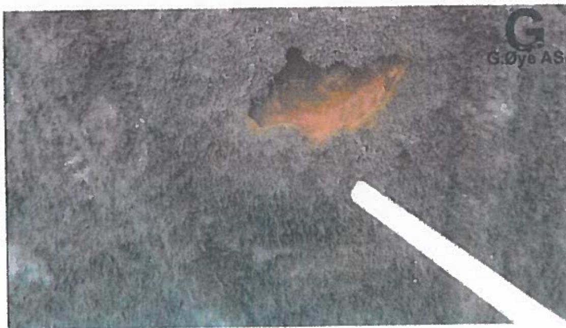
Rusthull i spuntvegg
