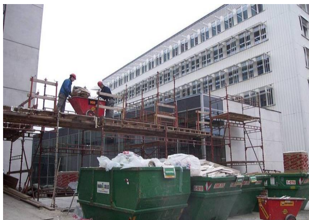
Bildet viser en byggeplass der avfallshåndteringen er planlagt slik at avfallet kastes ned i containere fra høyden. Restavfallsfraksjonen er plassert lengst unna for å stimulere til sortering. Foto: Sverre Valde.
