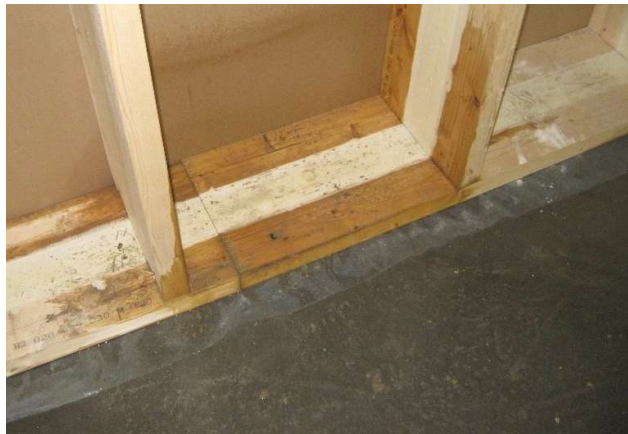
Figur 6-1: Eksempel på oppfuktet bunnsvill og vindsperre
