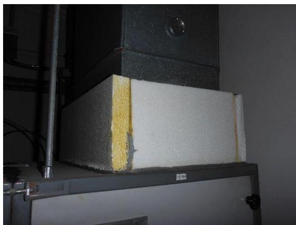
Bilde 24: EPS på ventilasjonsaggregat
