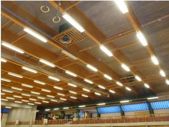
Bilde 26: Armatur og lysstoffrør
