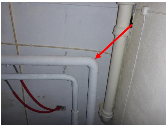
Bilde 3: Bend der det mistenkes asbest
