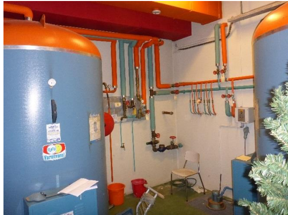
Bilde 2: EPS rørisolasjon, der bend må vurderes for asbest ved evt. riving.
