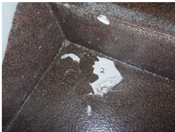
Bilde 6: Brunt epoxybelegg gulv
