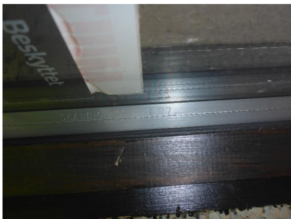
Bilde 21: Isolerglass med innhold av klorparafiner
