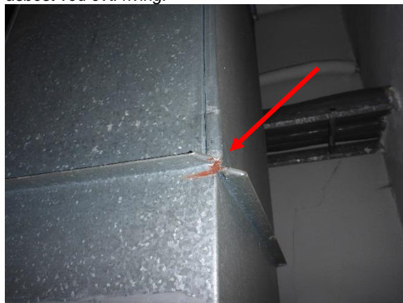
Bilde 4: Lim/tetningsmasse der det mistenkes asbest
