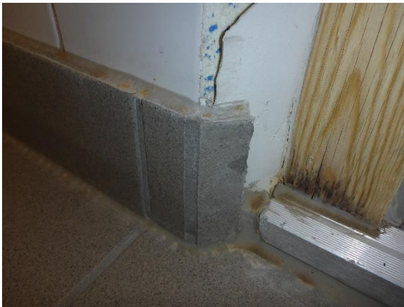
Bilde 13: Fuger damedusj
