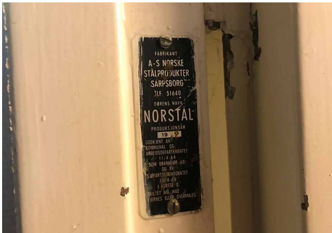
Bilde 15 – Bilde viser merking av branndør i kjeller, fra 1972. Erfaringsvis kan slike branndører produsert før 1985 inneholde asbest. Denne døren må derfor håndteres etter gjeldene forskrift for fjerning av asbest, saneres av godkjent personell og leveres som farlig avfall til godkjent mottak. Mengder i tabell, punkt 4.4.
