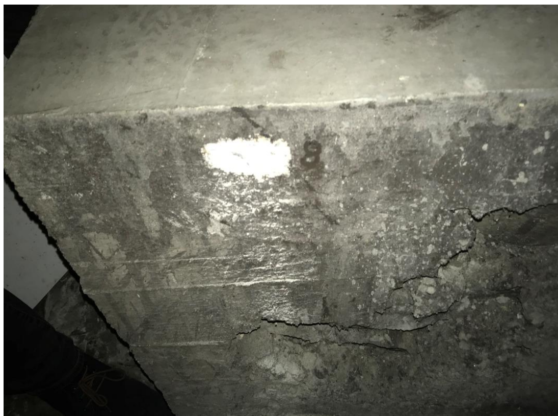
Bilde 6 – Bilde fra prøve 8. Betongdekke i kjeller ble analysert for PCB og tungmetaller (inkl. Krom-6). Prøven viser en forekomst av tungmetaller over normverdien for forurensede masser, mens forekomsten av PCB er under normverdien for forurensede masser. Massene må leveres som forurenset til godkjent mottak. Mengder i tabell, punkt 4.4.
