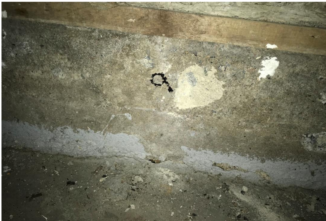
Bilde 7 – Bilde fra prøve 9. Plasstøpt betong fra grunnmur i kjeller ble analysert for PCB og tungmetaller (inkl. Krom-6). Prøven viser en forekomst av PCB og tungmetaller under normverdien for forurensete masser. Massene kan håndteres som rene.
