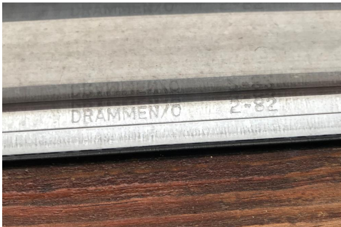
Bilde 9 – Bilde viser merking av isolerglassruter i bygget. Basert på produksjonsår 1982 antas det at disse vinduene inneholder klorparafiner og må derfor leveres som farlig avfall til godkjent mottak. Mengder i tabell, punkt 4.4
