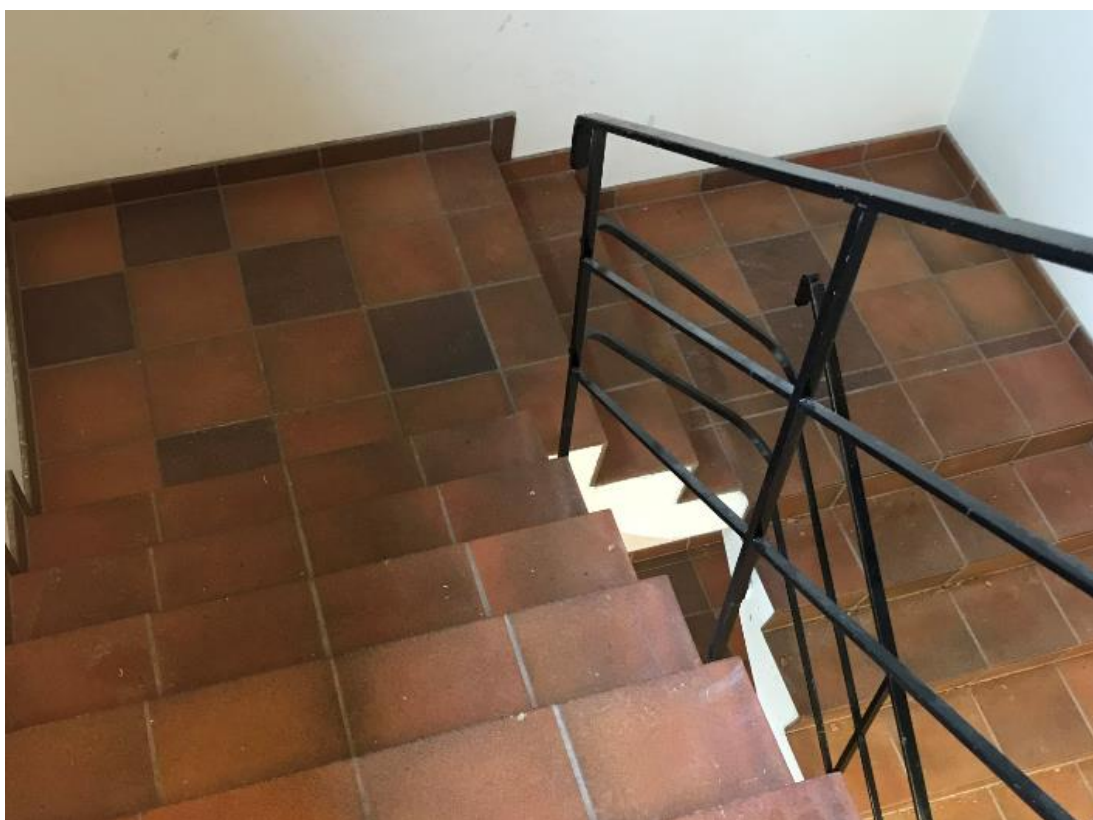
Bilde 12 – Bilde av flislagt trapp. Erfaringsvis kan fliser/fuger/lim inneholde mindre mengder PCB/tungmetaller/ klorparafiner. Betongen i trappen er også lett forurenset. Både betong og fliser/fuger/lim fra trappen må leveres som lett forurensete tungmasser til godkjent mottak. Mengder i tabell, punkt 4.4.
