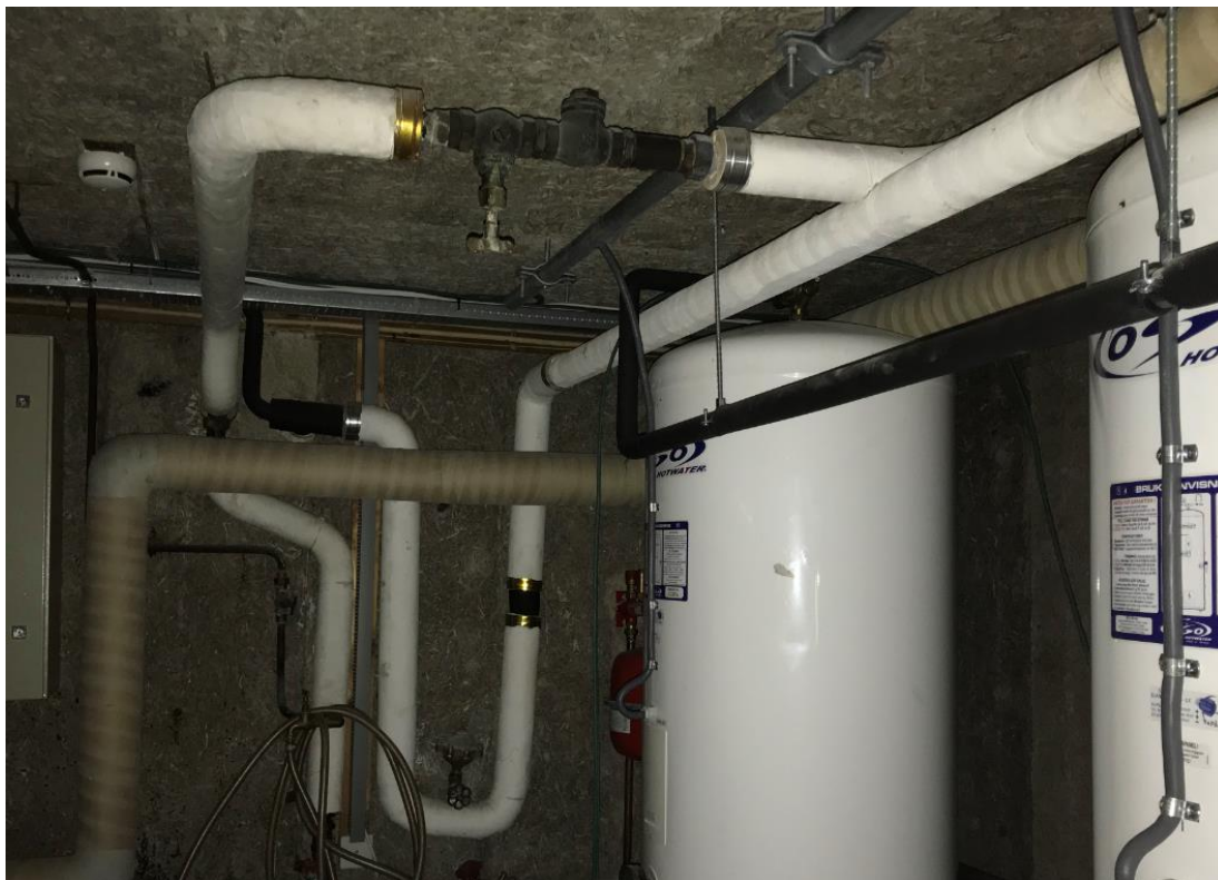
Bilde 17 – Bilde av hvit isolasjon på rør på fyrrom i kjeller. Erfaringsvis kan rørbend og endestykker av denne typen rørisolasjon inneholde asbest og må derfor håndteres etter gjeldene forskrift for fjerning av asbest, saneres av godkjent personell og leveres som farlig avfall til godkjent mottak. Mengder i tabell, punkt 4.4.
