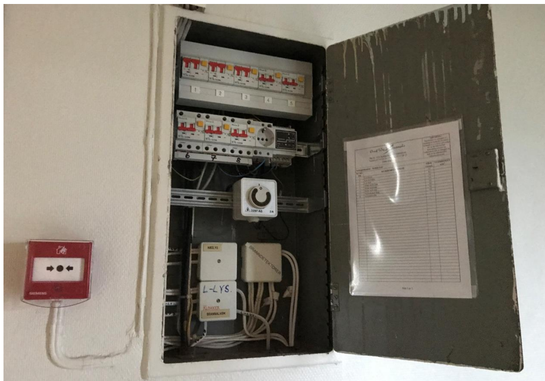
Bilde 13 – Bilde viser eksempel på EE-avfall i bygget. Panelovner, el-føringer, kabellister, ol. med elektriske eller elektroniske komponenter må leveres som egen fraksjon, EE-avfall, til godkjent mottak. Mengder i tabell, punkt 4.4.
