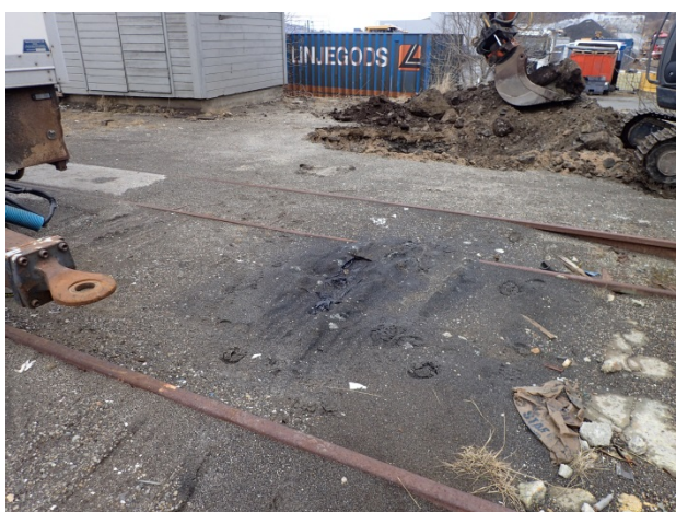
Bilde 9: Svart sand flere steder på området, som trolig inneholder rester fra sandblåsing.
