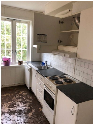
Viser kjøkken i 1 etasje hvor det er store vannskader.
