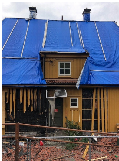
Viser fasaden mot sør som er hares berørt.
