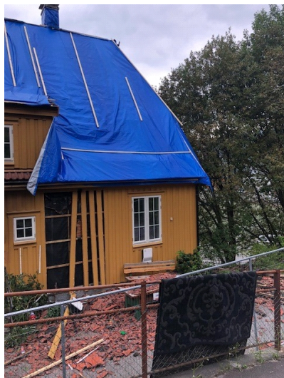
Viser fasaden mot sør hvor det har brent oppover i takkonstruksjonen.
