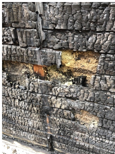
Viser hvor det har brent i veggkonstruksjonen like til venstre for inngangsdøren.
