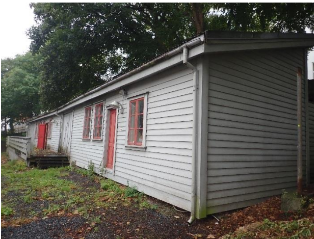
Bilde 3: Rød karmmaling på vindu og dører. Påvist tungmetaller
