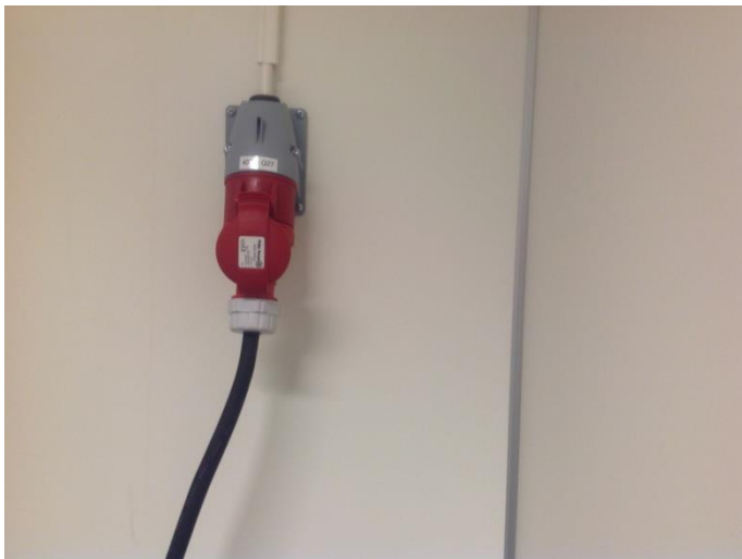
Fastmontert 3-fas strøm.
