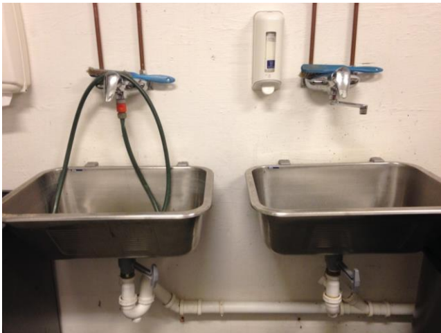
Utslagsvask. Bør kunne romme bløtlegging av gulvpad.
