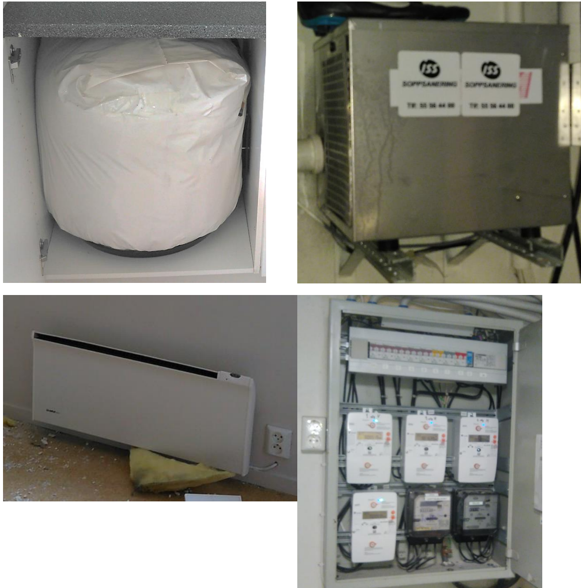
Figur 8: Varmtvannstank, el-apparat, panelovn og sikringskap.
