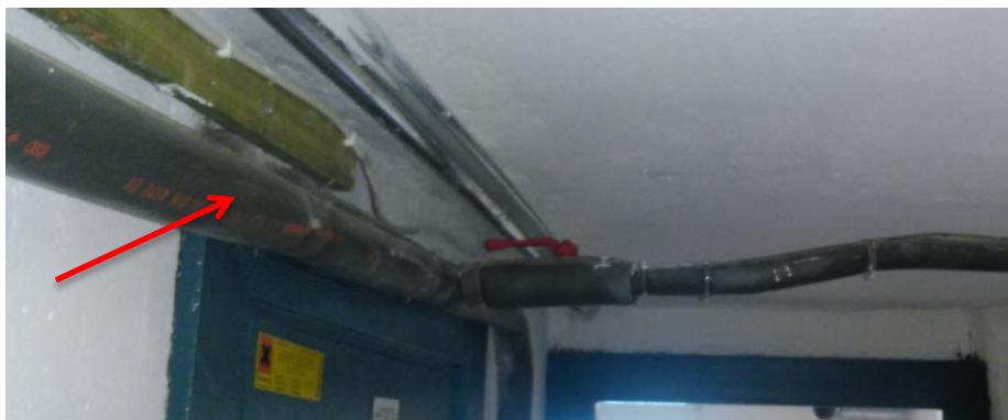
Figur 11: Cellegummi på rør i kjeller.
