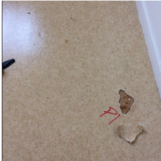
Figur 9: Vinylbelegg på gulv i stua i loftetasjen. Det ble påvist ftalater over grense for farlig avfall i vinylbelegget.
