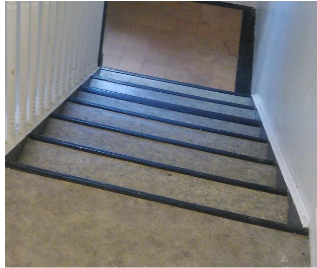
Figur 10: Myke trappelister i trappeoppgang.
