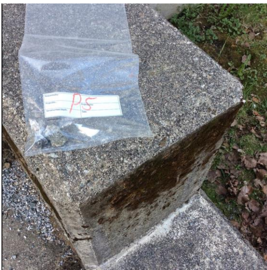
Figur 18: Umalt betongtrapp ved nordøstre fasade. Det ble påvist krom VI over normverdi, men under grenseverdi for farlig avfall i betongen.
