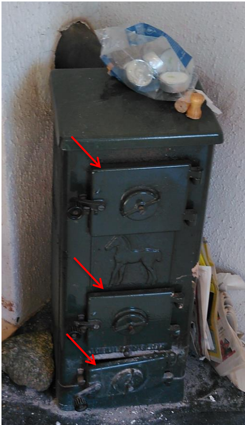
Figur 7: Hvit-grå isolasjon i pakning i vedovnsdører. Det antas å være asbest i pakningene.
