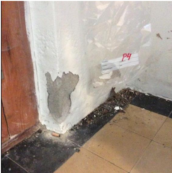
Figur 19: Malt murvegg, trappeoppgang, 1. etasje (P4). Det ble påvist PCB over normverdi, men under grenseverdi for farlig avfall i malingen.
