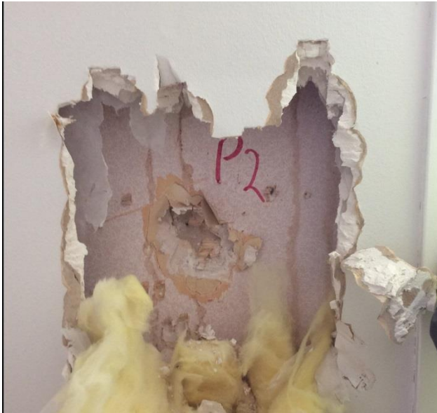
Figur 5: Prøvetatt plate (P2) bak gipsplate og isolasjon i vegg mot nordvest. Det ble ikke påvist asbest i platen.
