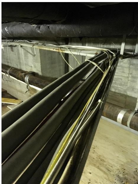
Kabelbro for føring til fordelingstavle i Aula.
