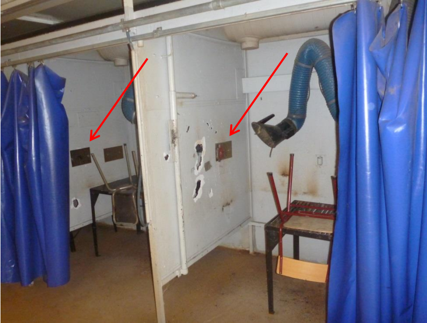
Asbestoluxplate i sveisebåser, 5-020
