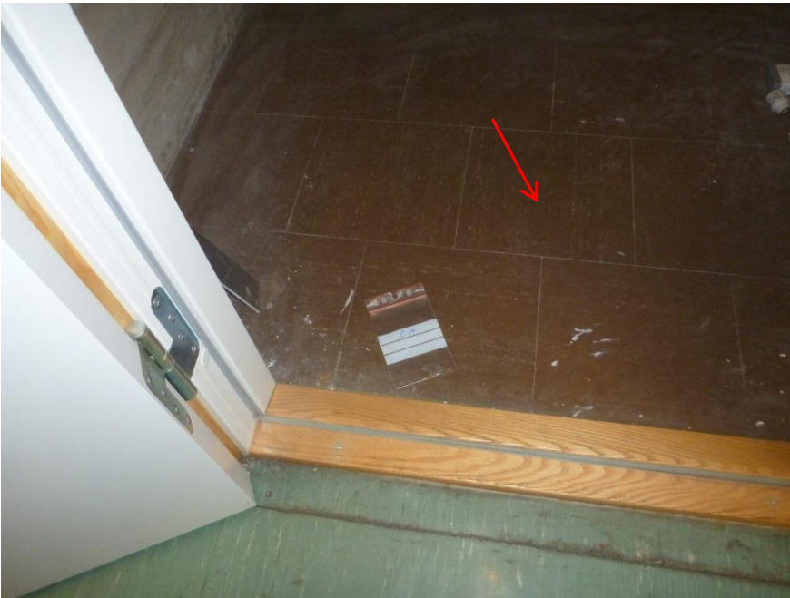
Rikettflis med asbest i 5-018
