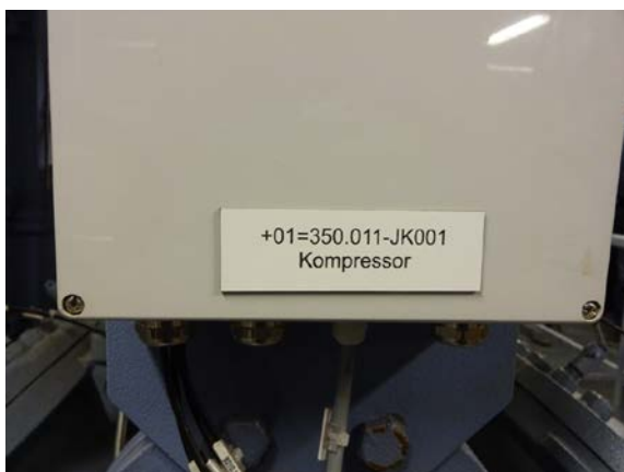
Kompressor er merket med komponentkode JK og løpenummeret er 001. Kompressor er en del av systemet 350.011.
