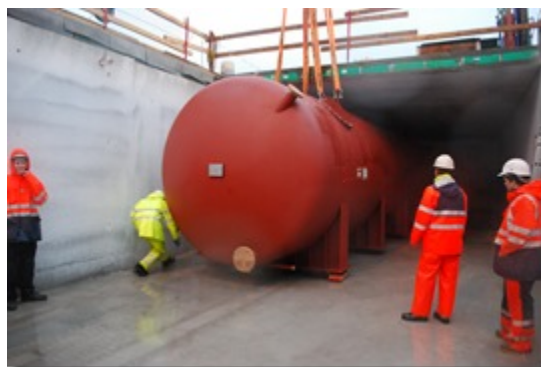
Figur 7.4: Kuldagertank under installasjon på høyskolen i Bergen
