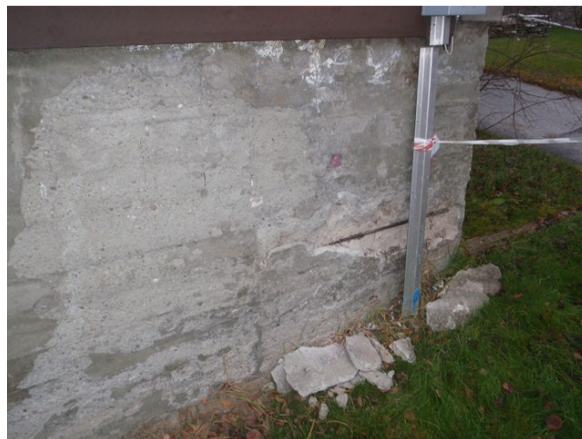
Bilde 8: Utvendig kjellervegg med avskallinger.
