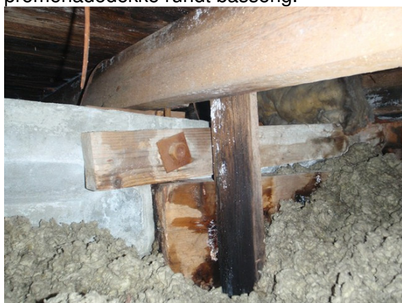
Bilde 11: Mye fukt i takkonstruksjoner som følge av luftlekkasjer fra hallen.
