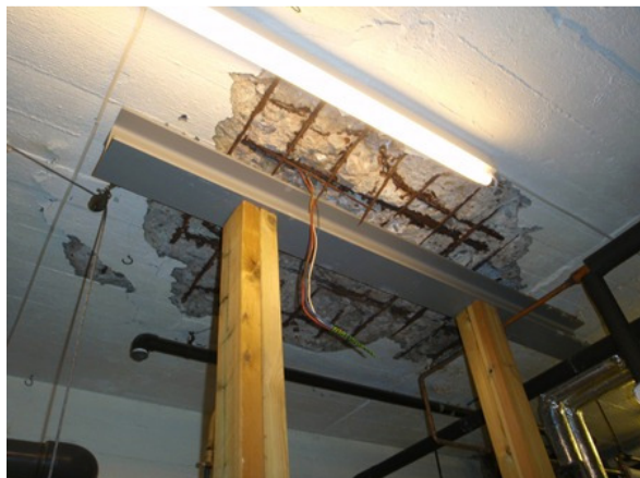
Bilde 7: Armeringsavskalling i tak i teknisk rom i kjeller. Understøttet med bjelke.
