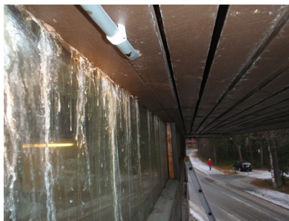
Bilde 10: Utvendig vindu i svømmehall er preget av luftlekkasjer og kondens.
