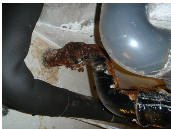
Bilde 17: Avløpsrør i støpejern med korrosjon (bilde rotert).
