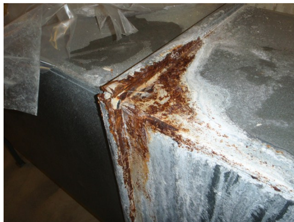
Bilde 14: Korrosjon på ventilasjonskanaler fra 1994, pga lekkasjer fra taket (promenadedekke).
