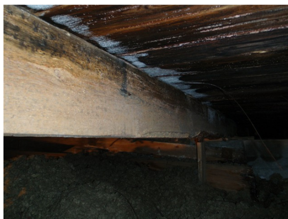
Bilde 12: Undertak i kryprom er våt av kondens (det hvite er rim).
