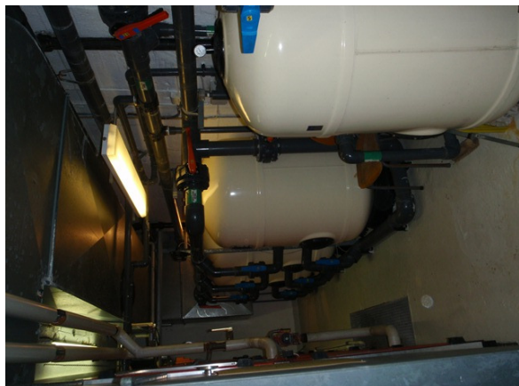
Bilde 13: Teknisk anlegg (trykksandfiltere). (Bilde rotert)
