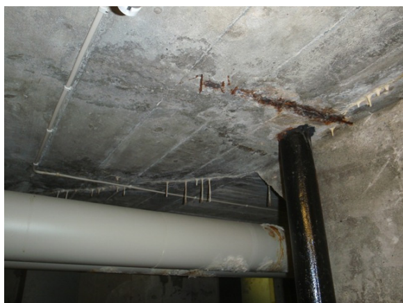
Bilde 9: Typisk bilde av riss med lekkasjer og armeringsavskalling på underside av promenadedekke rundt basseng.
