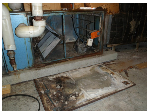
Bilde 16: Aggregat fra 1964 for garderobeanlegg.
