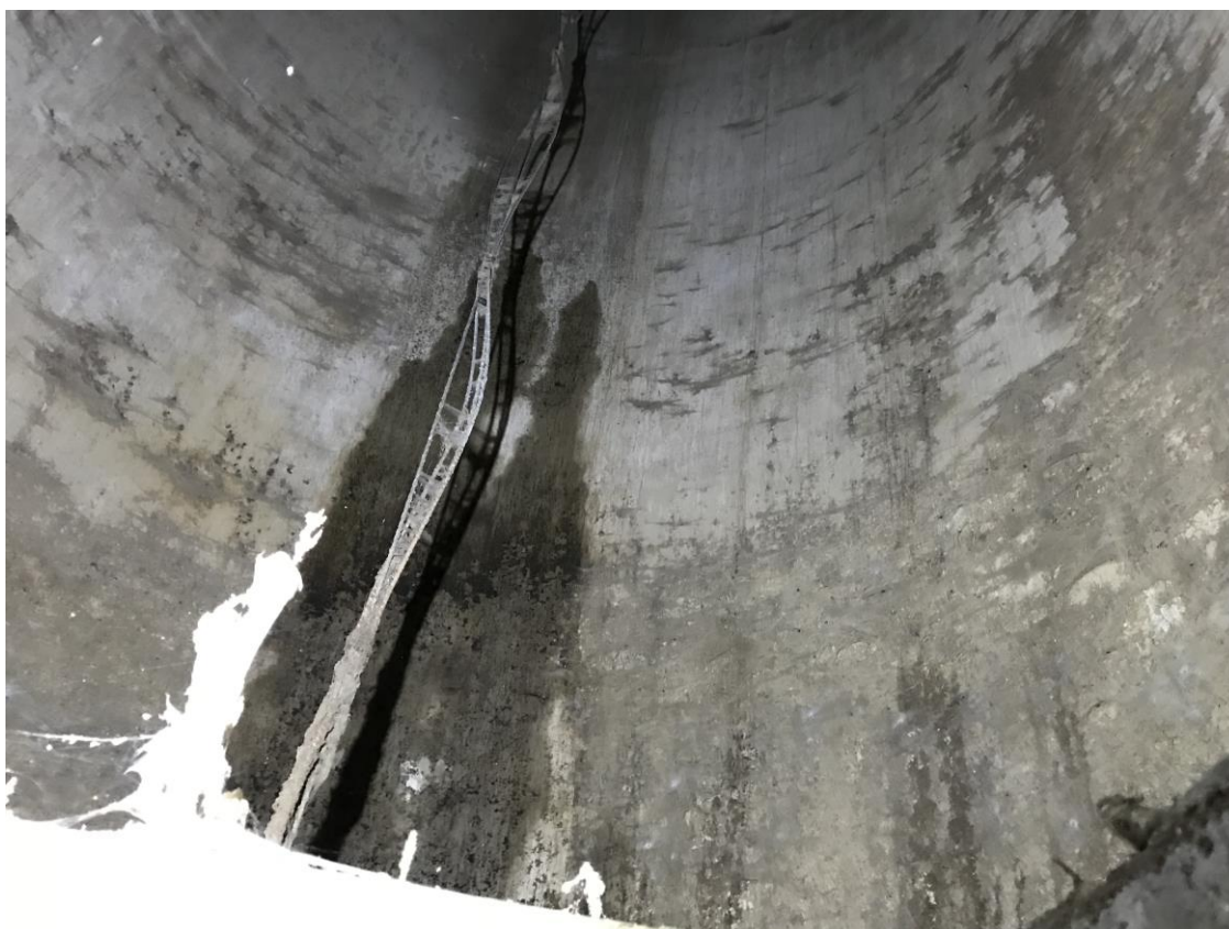
Bilde tatt innvendig i silorør. Omfattende lekkasjer fra gjennomgående sprekker
