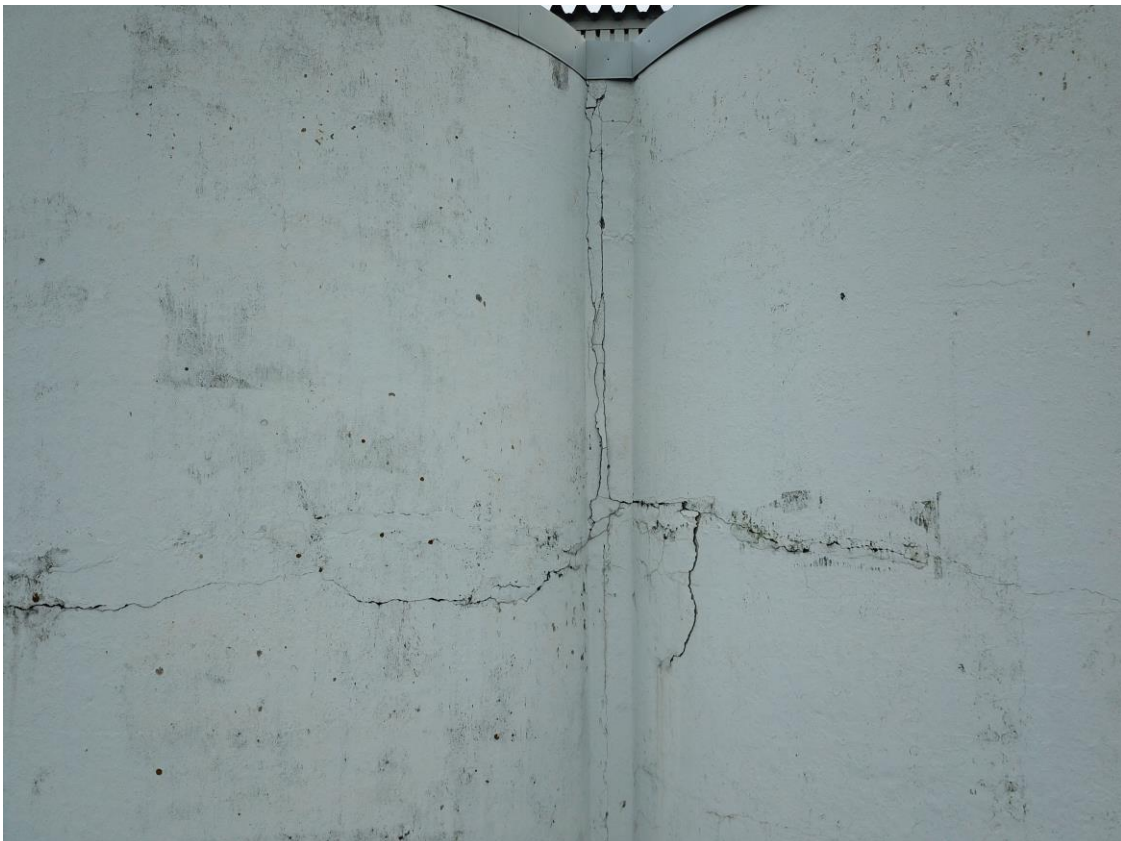
Foto fasade mot vest. Oppsprekking som følge av korrosjon på armering.
