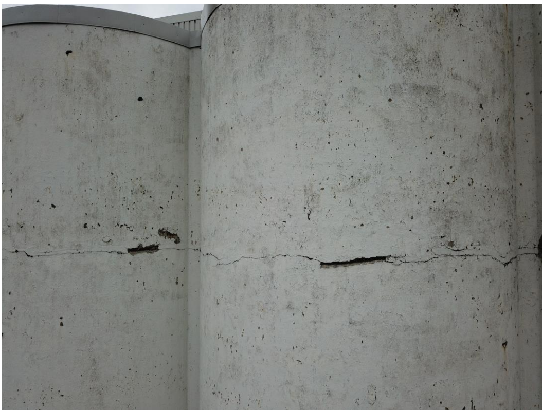
Foto fra fasade mot øst. Sprekker som er utbedret tidligere sprekker opp på nytt.
