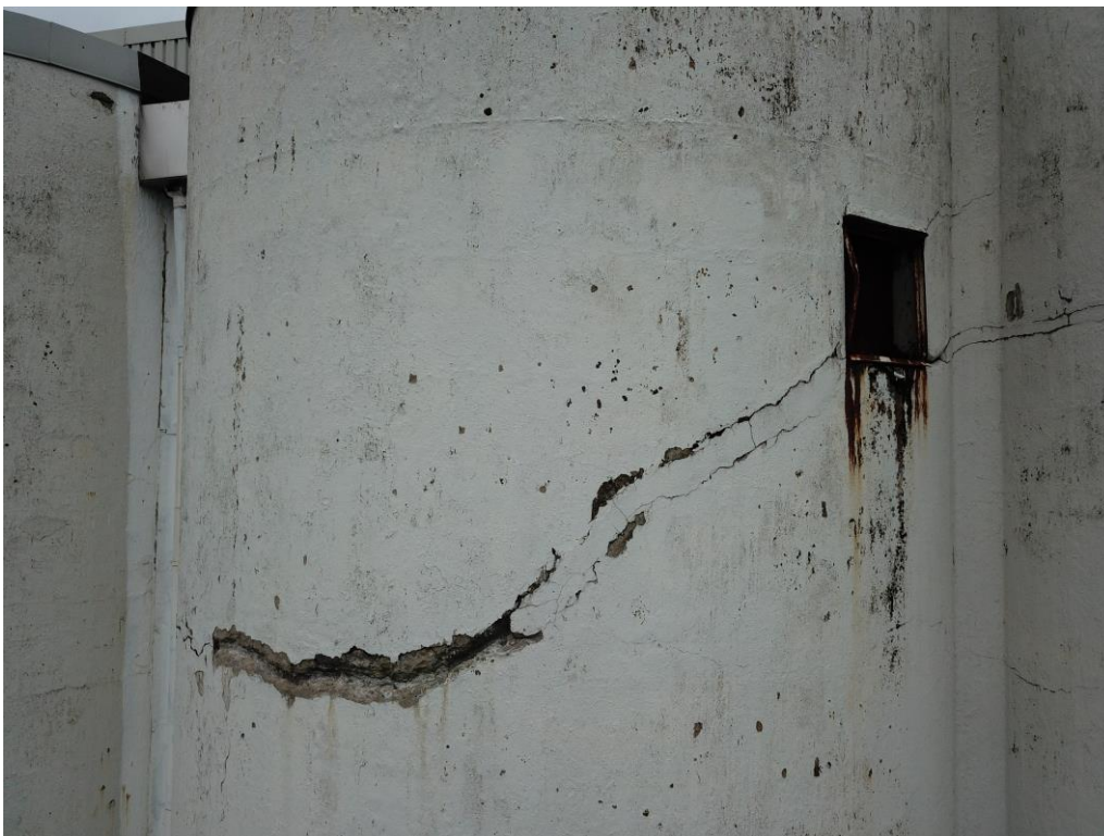
Silo nr 6 fra syd fasade øst. Gjennomgående sprekker tidligere utbedret, men reparasjoner skaller av.
