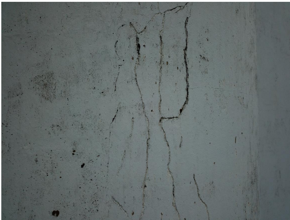
Foto fasade mot øst. Område med omfattende oppsprekking. Tidligere reparasjon av sprekkene ikke vellykket.
