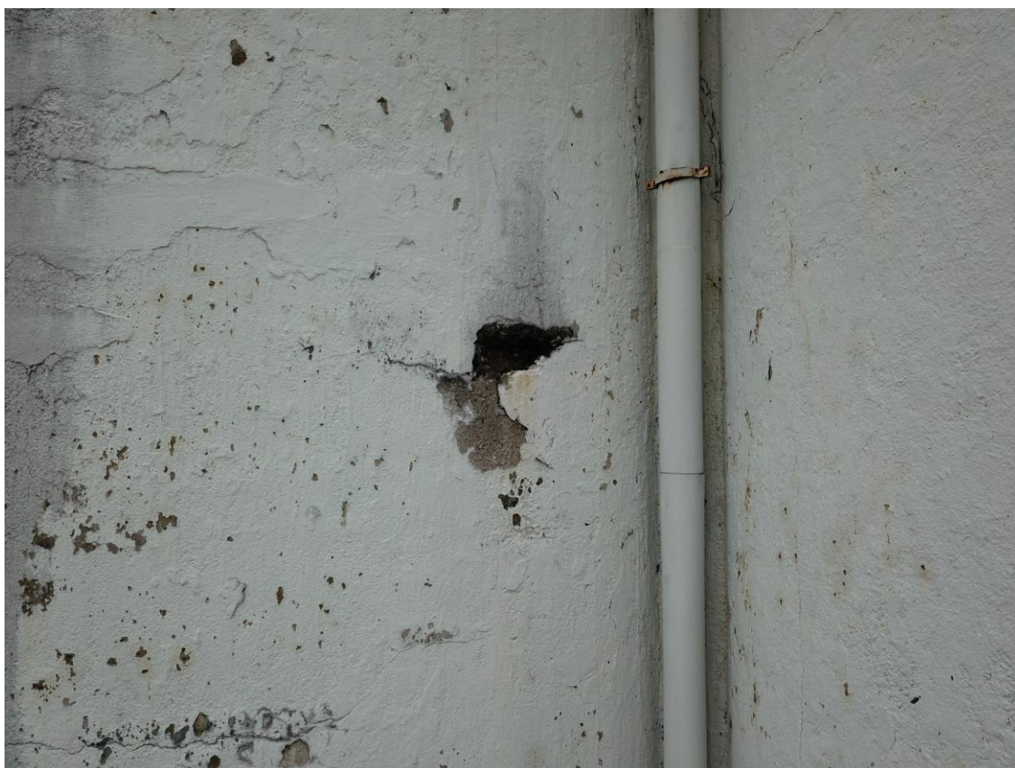
Foto av fasade mot vest. Avskalling på grunn av korrosjon på armering. Værslitt og medtatt overflatebehandling.
