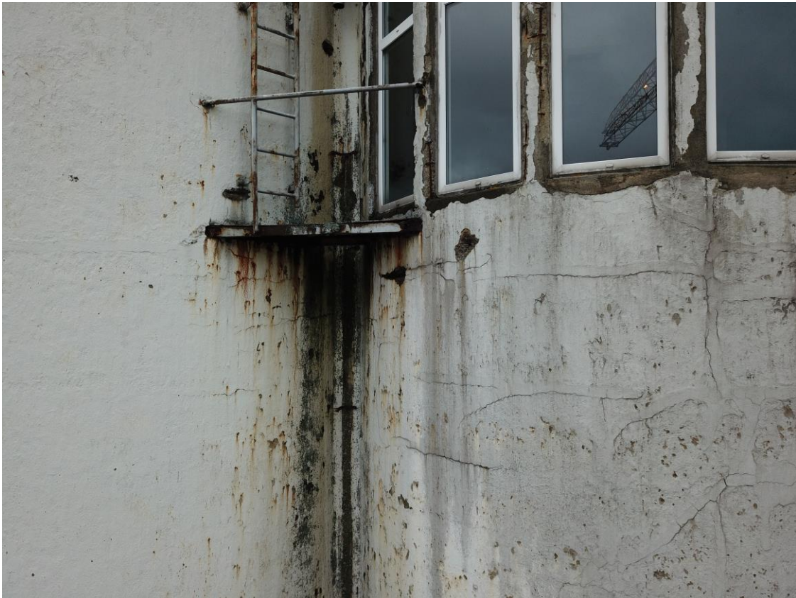
Foto fasade mot syd. Svært fuktutsatt parti, omfattende oppsprekking og korrosjon på armeringen.
