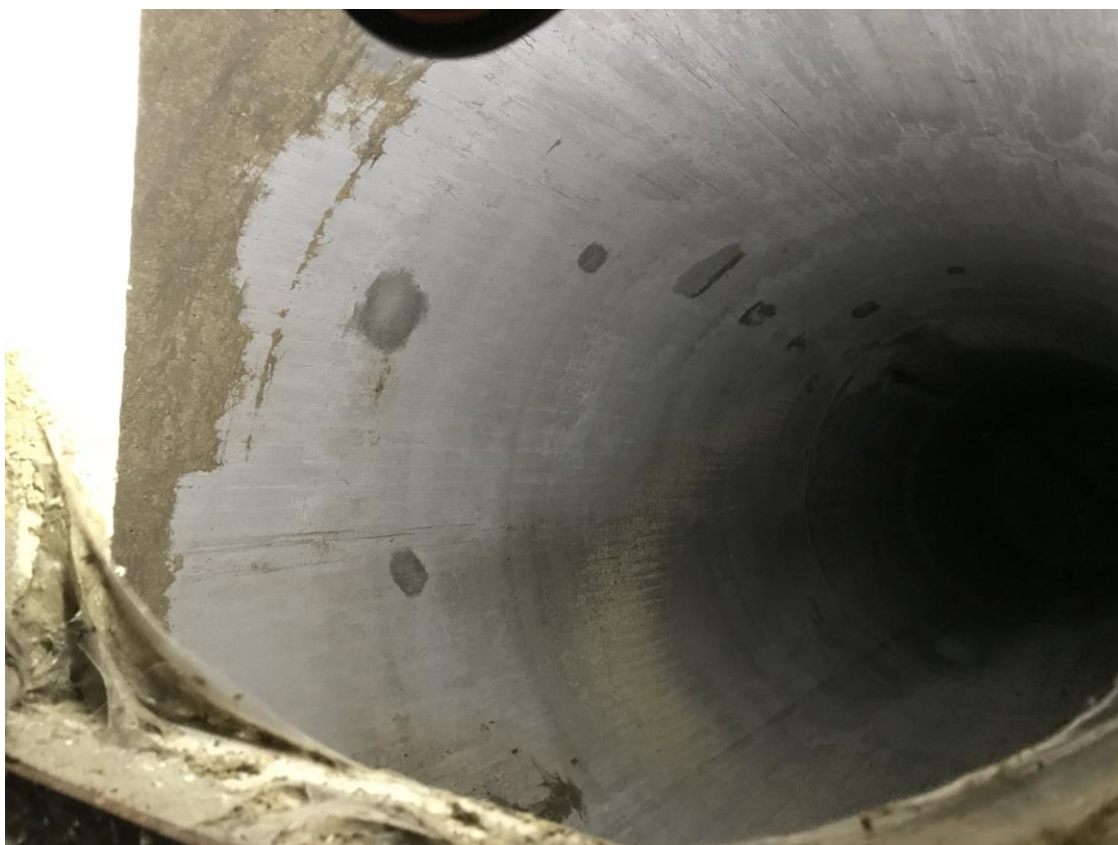
Bilde tatt innvendig i silo. Flere tidligere reparasjoner. Deler av armering ligger her i karbonisert betong, og armering med liten overdekning korroderer.
