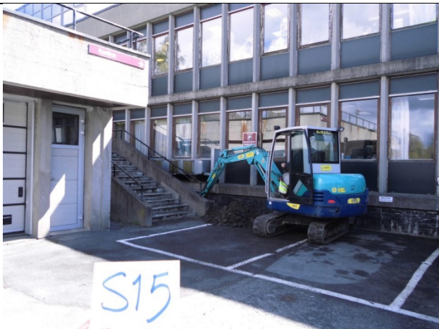
Foto 3. Graving i prøvepunkt S15, mellom trapp og vegg.
