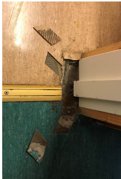
Bilde 4: Vinygulvbelegg med ftalater.
