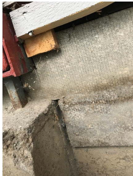
Figur 1: Eternittplate på grunnmur.
