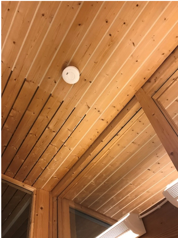
Bilde 1: Hvit fugemasse i innvendig himling
