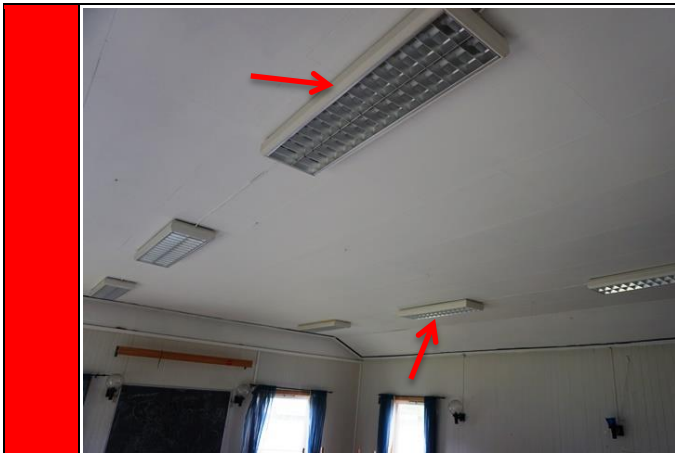
Bildet viser lysarmaturer i sal i 1. etasje.
