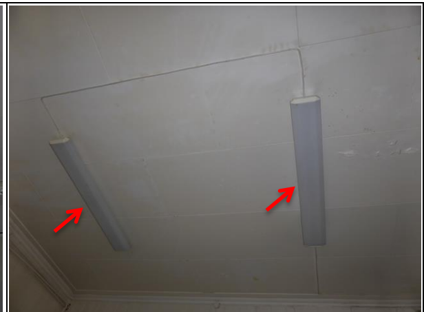
Bildet viser lysarmaturer.
