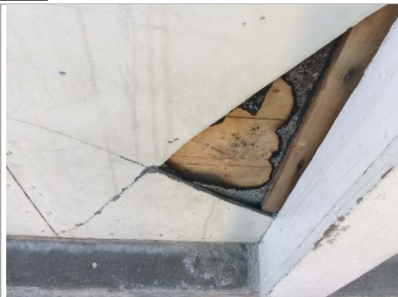
Bilde 1 Eternittplater på fasade under vindu SFO bygg
