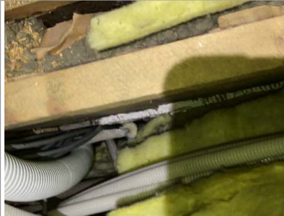
Bilde 3 Eternittplater innvendig under kledning rom 128 gang SFO
