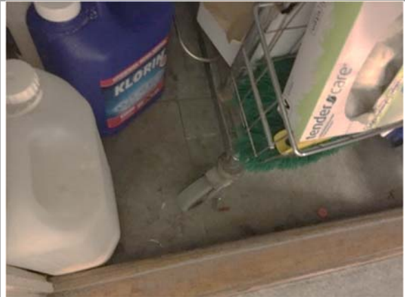
Bilde 4 Vinylfliser med asbest rom 130 SFO
