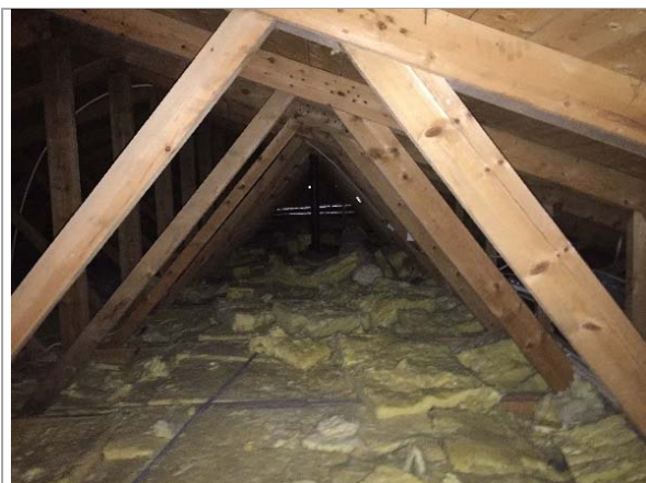
Bilde 10 Isolasjon mellom loft og 1. etg SFO Bygget
