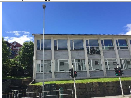
Bilde 7 Mulige asbest veggplater overkant øverste vindusrad på fasade mot hovedvei
