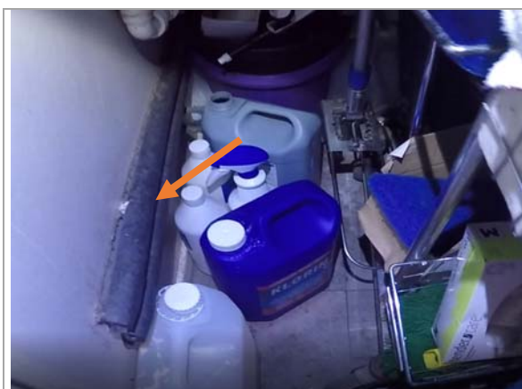
Bilde 12 Rørisolasjon rom 130 BK SFO
