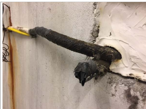
Bilde 14 Mistanke om PAH i eldre kabel for elektro
