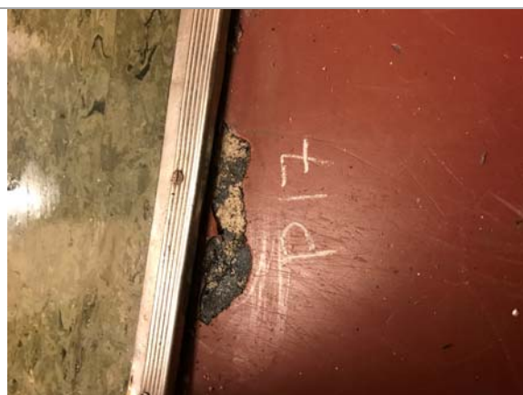
Bilde 4 Prøve 17 asbest gulvbelegg rom 127 ungdomsskolen
