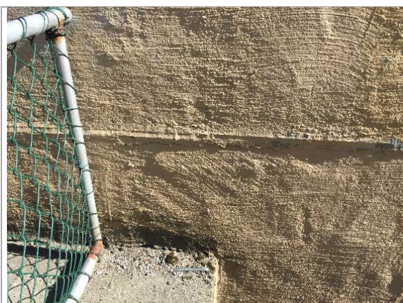
Bilde 11 Fuge i yttervegg gymbygg
