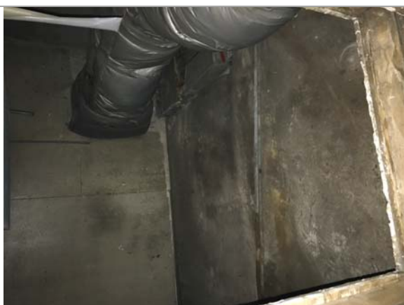
Bilde 3 Asbestplater ventilasjonsrom loft gymbygg
