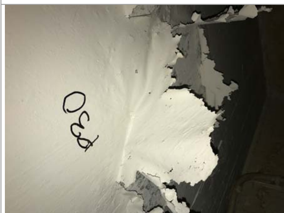
Bilde 13 Prøve 13 malig tak tilfluktsrom gymbygg
