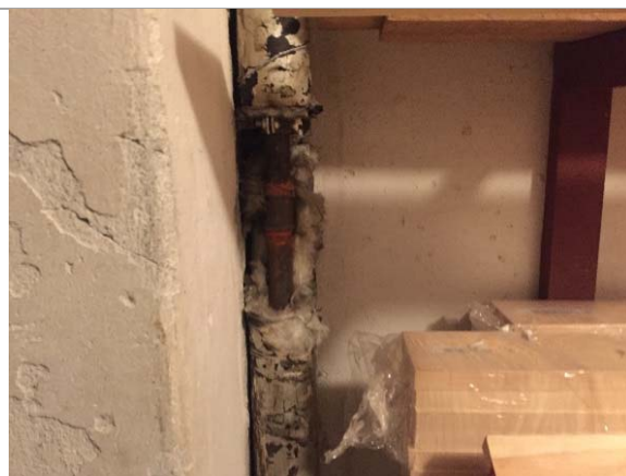
Bilde 10 Rørisolasjon av glassvatt, ungdomsskolen
