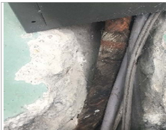
Bilde 15 Mulig tjærebelagt kabel til hovedtavle ungdomsskolen
