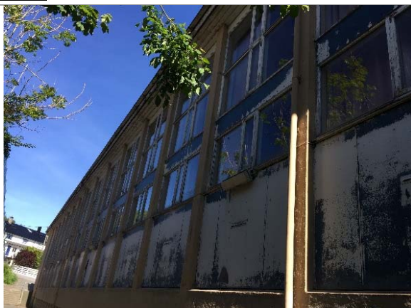
Bilde 1 Asbest veggplater på sørvendt fasade gymbygg
