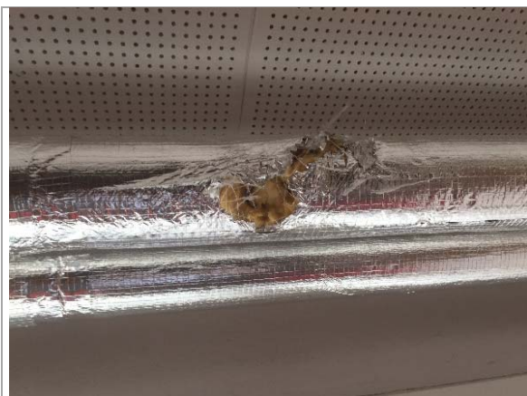
Bilde 9 Rørisolasjon av mineralull, gymbygg
