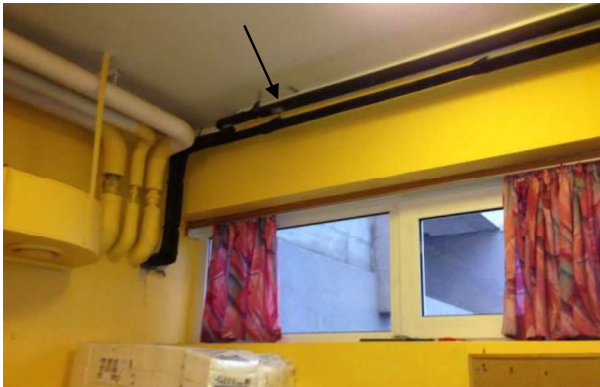
Bilde 20. Cellegummi som rørisolasjon. Her i 021 lager.
