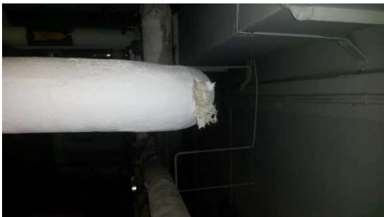
Bilde 6. U. etg. Tilfluktsrom. Ventilasjon. Bend på rørisolasjon, P4.
