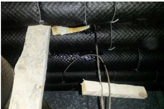
Bilde 31. Sort lim på rørisolasjon, P12.
