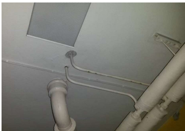
Bilde 14. U.etg. 021 Lager. Foring rundt rør ved gjennomføring mellom etasjer/rom, P15.
