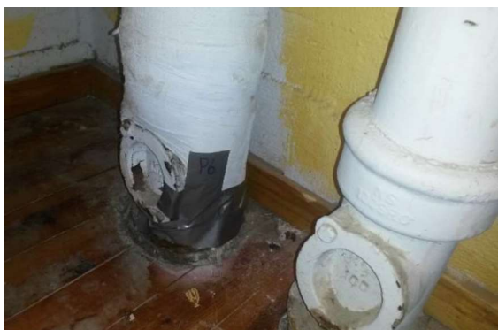
Bilde 8. U.etg. 004 Sløyd. Ende på rørisolasjon, P6.
