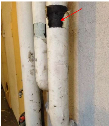
Bilde 21. Cellegummi som rørisolasjon. Her i ventilasjonsrom, under lag med «gassbind».
