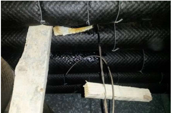
Bilde 11. U.etg. 040 korridor utenfor gymsal. Lim på rørisolasjon i himling, P12.
