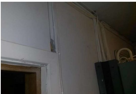
Bilde 4. U. etg. tilfluktsrom. Nødstrøm. Veggplate, P2.
