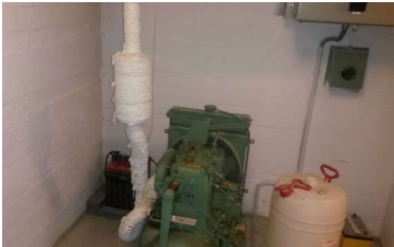
Bilde 5. U. etg. tilfluktsrom. Nødstrøm. Isolasjon på nødstrømsaggregat, P3.
