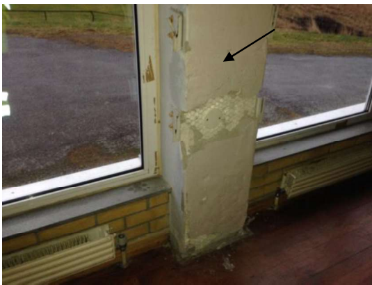
Bilde 30. Murpuss på søyle, P11.
