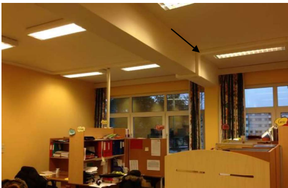
Bilde 16. Eksempel på kabelskinner, 101 Arbeidsrom for lærere.
