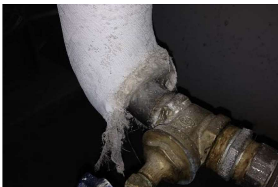
Bilde 7. U.etg. Tilfluktsrom. Ventilasjon. Ende på rørisolasjon, P5.
