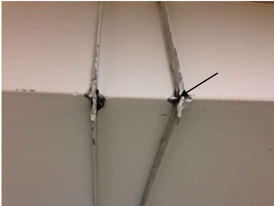
Bilde 29. Skjøl på ventilasjonsanlegg i tilfluktsrom, P1. Sort. Farlig avfall med asbest
