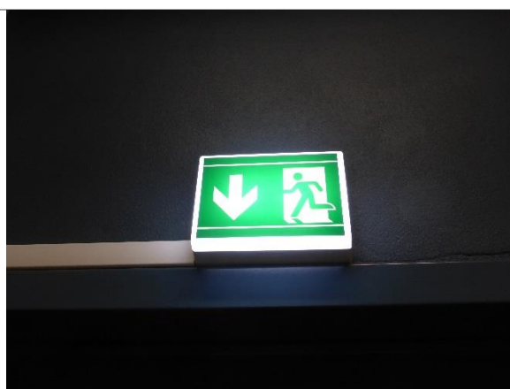
Bilde 26: Lede-/nødsilt med batteripakke
