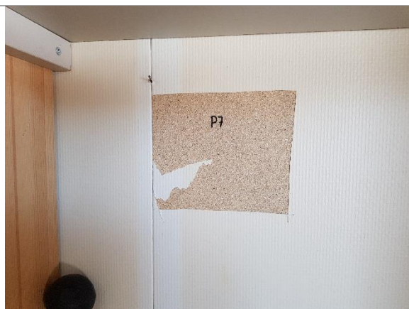
Bilde 12: Veggfolie, bygg 3
