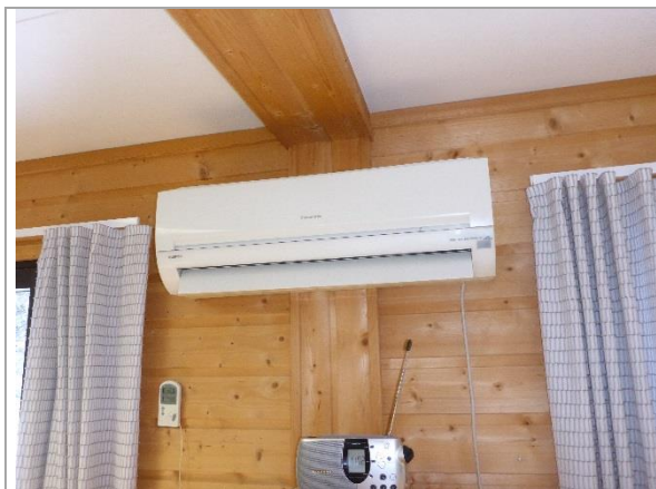
Bilde 22: AC-enhet bygg 1
