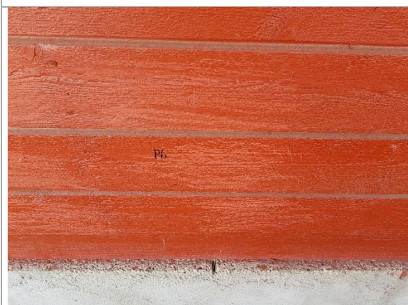
Bilde 4: Maling, yttervegg
