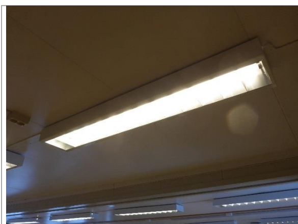
Bilde 25: Armatur og lysstoffrør
