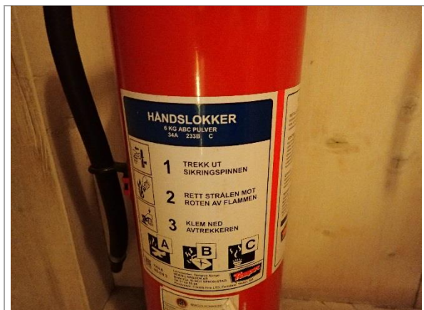
Bilde 15: Pulverapparat i 3. etasje.
