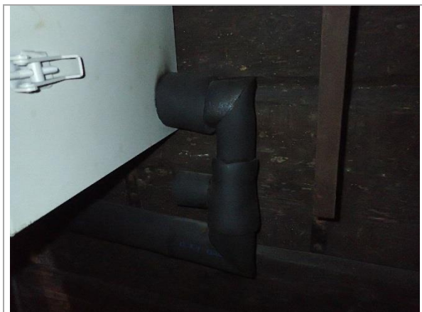
Bilde 14: Rørisolasjon av cellegummi.
