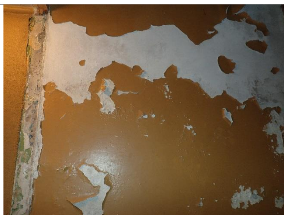
Bilde 5: Maling i rom 109 er lavforurenset av PCB.
