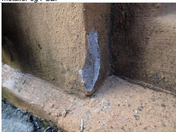
Bilde 9: Utvendig murpuss og maling er lavforurenset av metaller.
