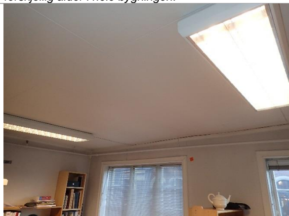
Bilde 19: Belysning på kontor i 2. etasje.
