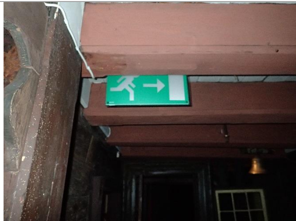
Bilde 17: Det er observert nød- og ledelys av forskjellig alder i hele bygningen.
