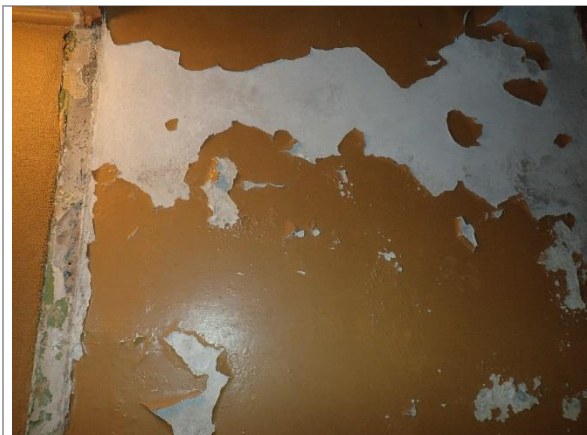
Bilde 6: Maling i rom 109 er farlig avfall.
