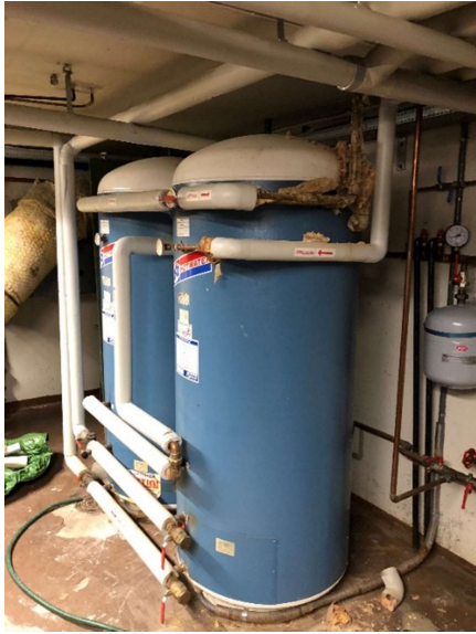
Figur 1 Eksisterende VV-beredere teknisk rom
