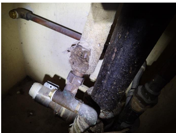
Bilde 4: Enkelte rør i 3. etasje er isolert med jute/hamp, uten asbestpapp mot rør.
