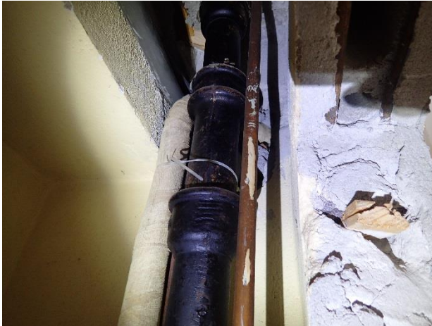
Bilde 6: Eksempel på solirør, dette i 3. etasje.
