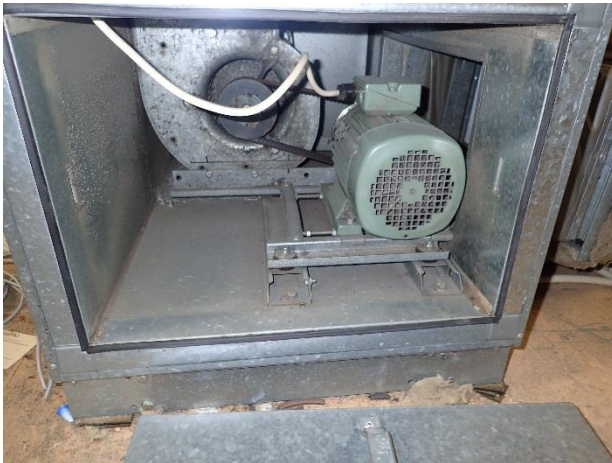
Bilde 15: Vifteanlegg på loft.
