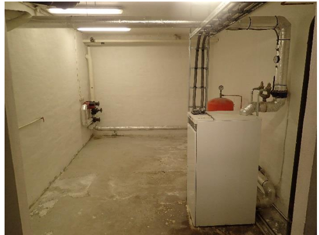
Bilde 16: El-kjel i underetasjen.
