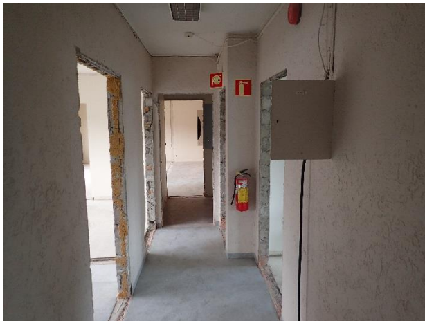
Bilde 9: Innvendig maling inneholder mye sinkoksid, bilde fra korridor i 2. etasje.
