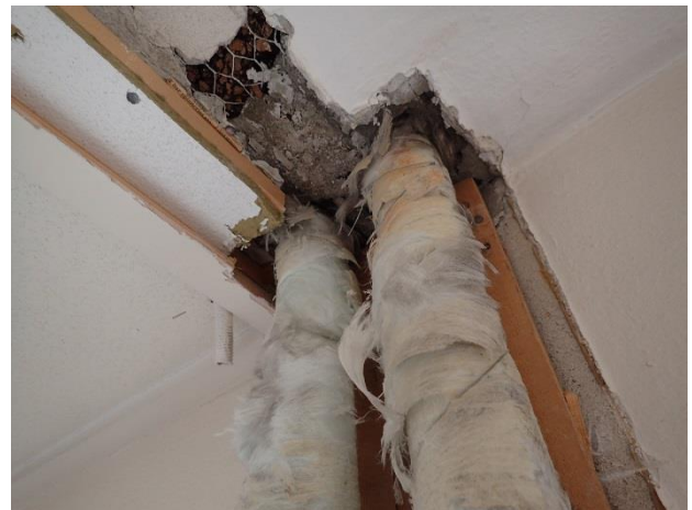
Bilde 3: Rørføringer i 2. etasje er isolert med glassvatt.
