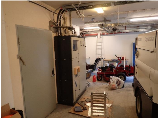
Bilde 13: Tavle i underetasjen.
