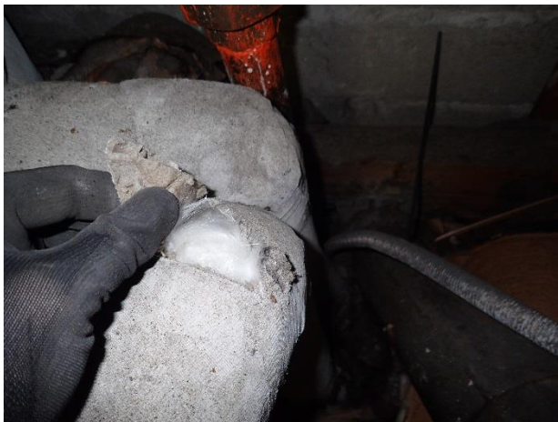
Bilde 2: Bend ved ekspansjonstank på loft inneholder kun glassvatt.
