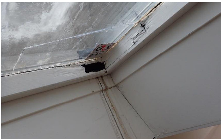
Bilde 1 – Det mest ødelagte takvinduet har råttten karm.
