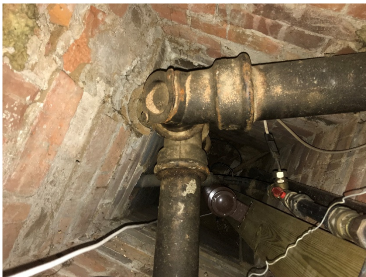
Figur 1: Soilrør med blyskjøter under bygn. 0049.
