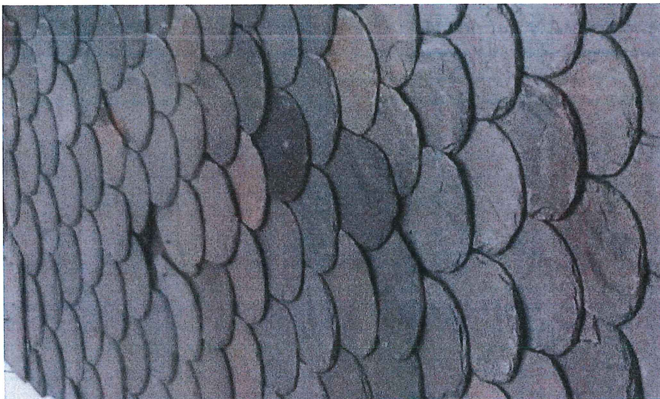
Ordre O2353. Filnavn: 20170606_080423.jpg. Beskrivelse: Stein mangler på hovedtak mot inngang.
