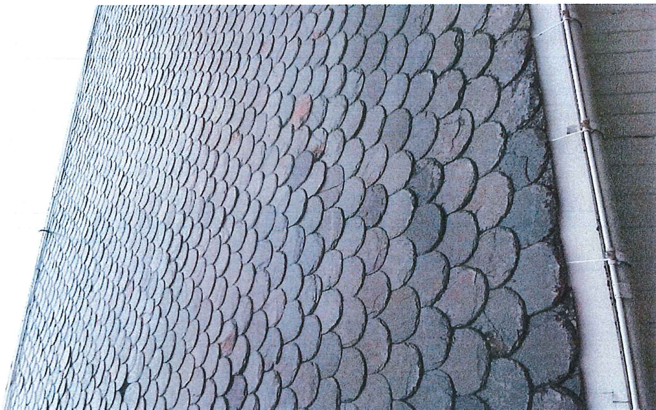
Ordre O2353. Filnavn: 20170606_080406.jpg. Beskrivelse: Hovedtak, hull og sprekte steiner.
