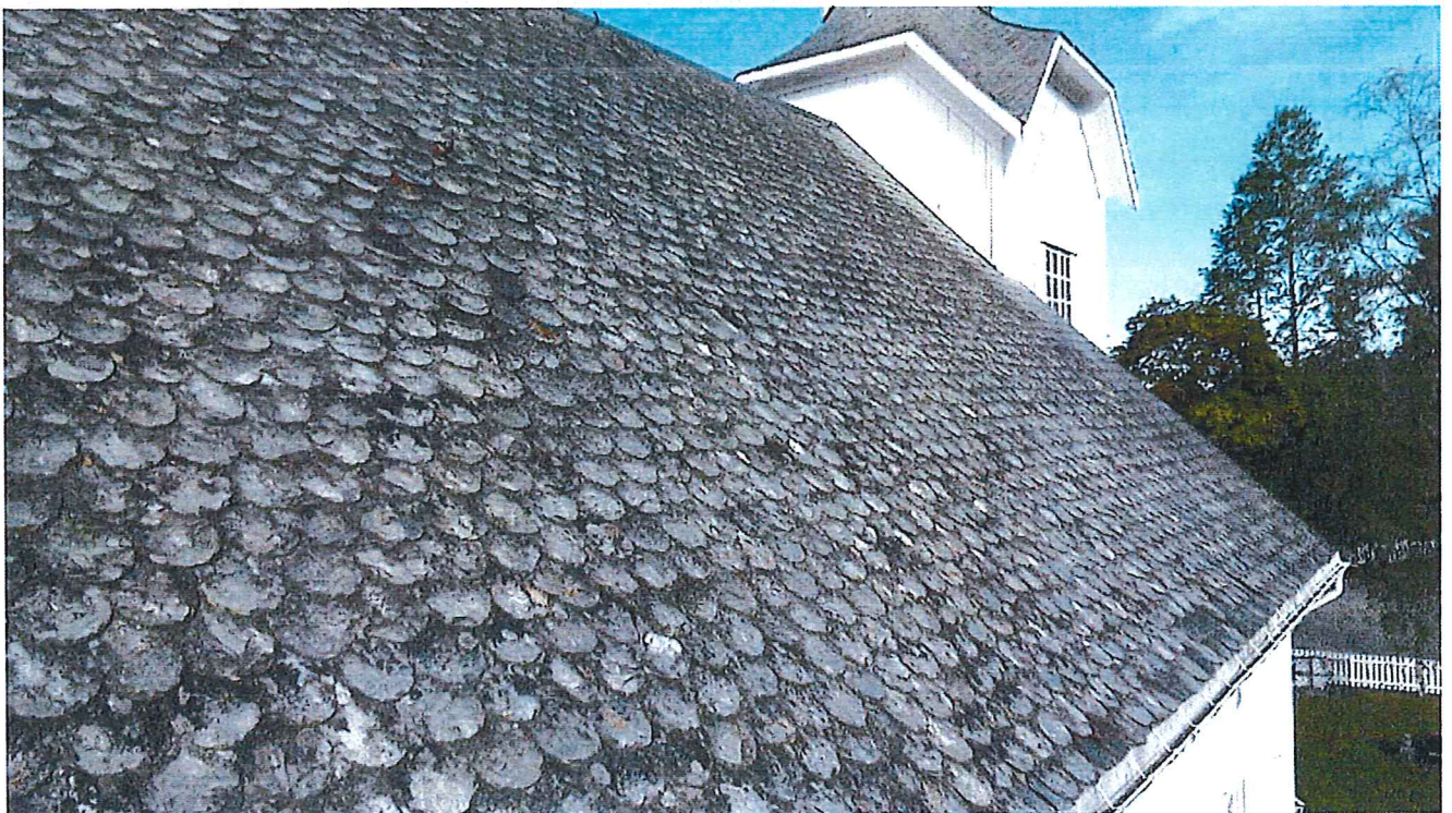
Ordre O2353. Filnavn: P_20170619_074304.jpg. Beskrivelse: oversiktsbilde hovedtak mot veien. mangler 4 steiner på denne siden.
