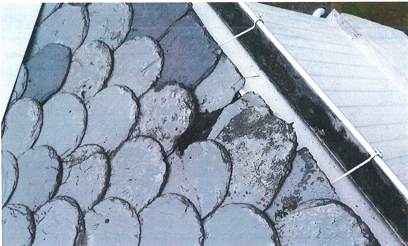
Ordre O2353. Filnavn: 20170606_092506.jpg. Beskrivelse: tak ved siden av sakresti, dårlige bord der det mangler stein.
