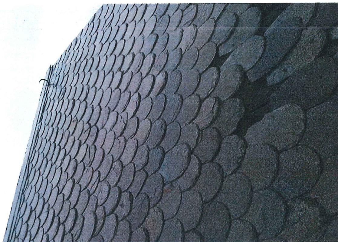
Ordre O2353. Filnavn: 20170606_092826.jpg. Beskrivelse: Hovedtak, stein mangler, underpapp ser bra ut.
