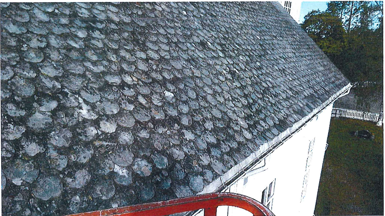
Ordre O2353. Filnavn: P_20170619_074323.jpg. Beskrivelse: hovedtak mot vei. mangler fire steiner. undertak ok.
