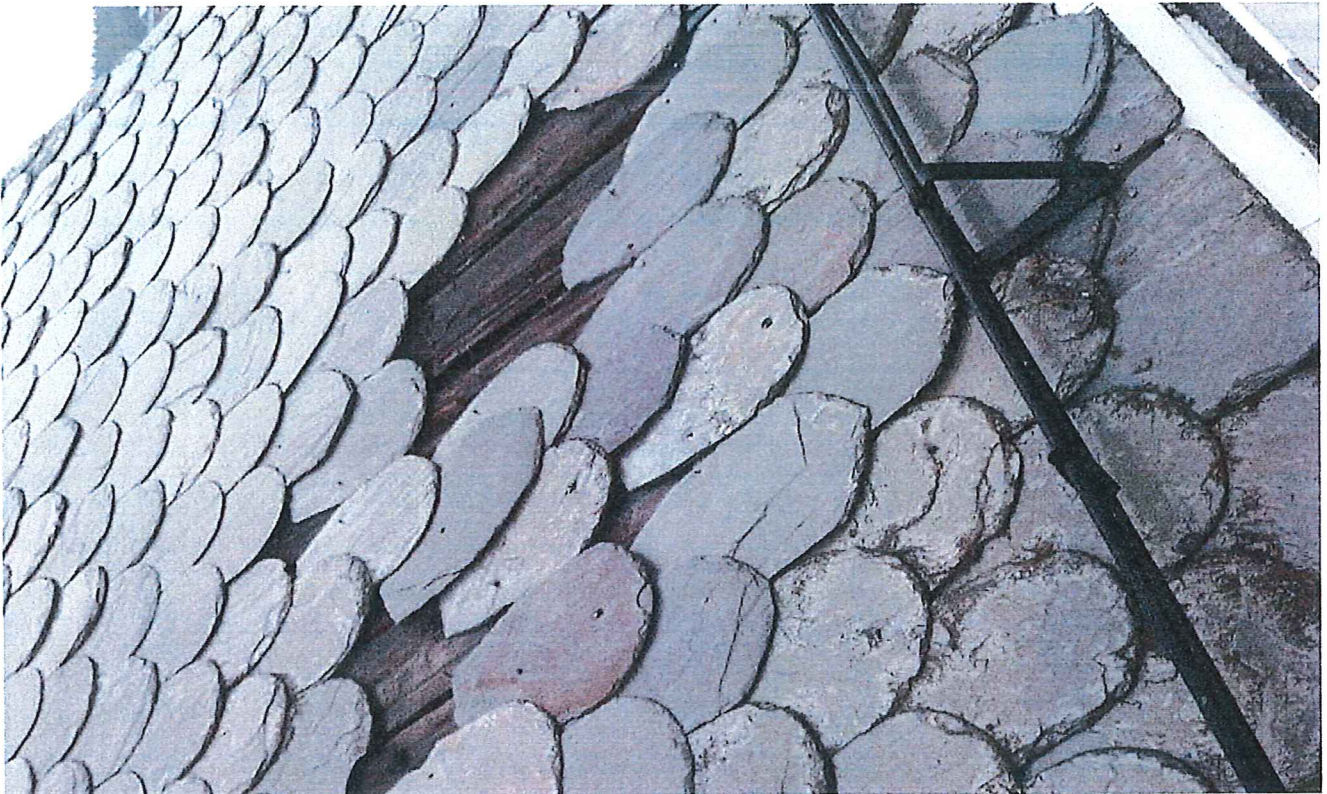
Ordre O2353. Filnavn: 20170606_092816.jpg. Beskrivelse: Tak over sakresti, steiner mangler og det er dårlige bord.
