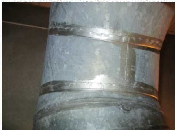
Bilde 3.2 Sølvfarget tettemasse Personalbygg
