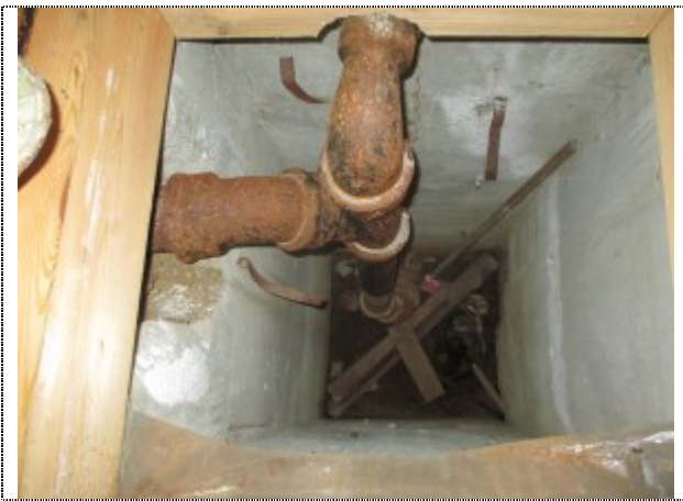
Bilde 3.7 Soilrør Gymsal 2
