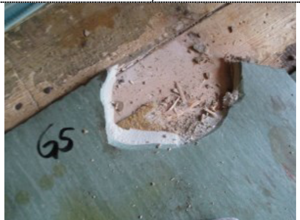
Bilde 3.6 Vinyl som er asbestholdig i gymsal
