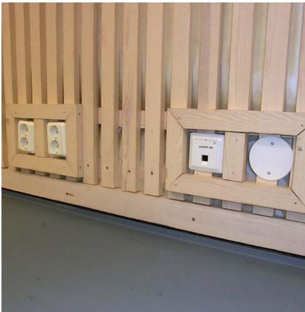
Beskyttelse av elektriske installasjoner Foto: Morten Roa
