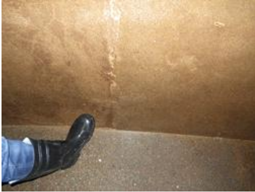
Bilde 1 - Overgang GPG og vegg.
