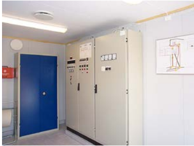
Elektroskap i de nye anlegg.
