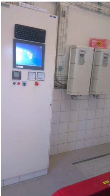
Elektroskap i nye anlegg
