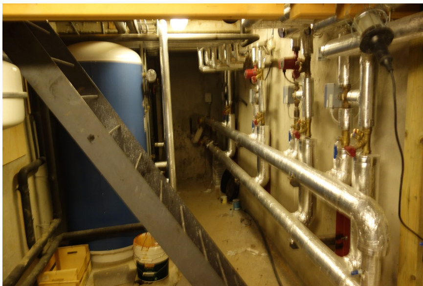
Figur 0.2 Teknisk rom i kjeller
