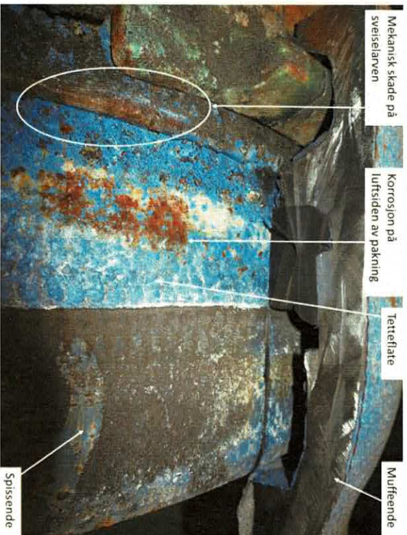
Figur 5 Muffekobling 1, sett innvendig i muffekoblingen, muffe delvis fjernet
