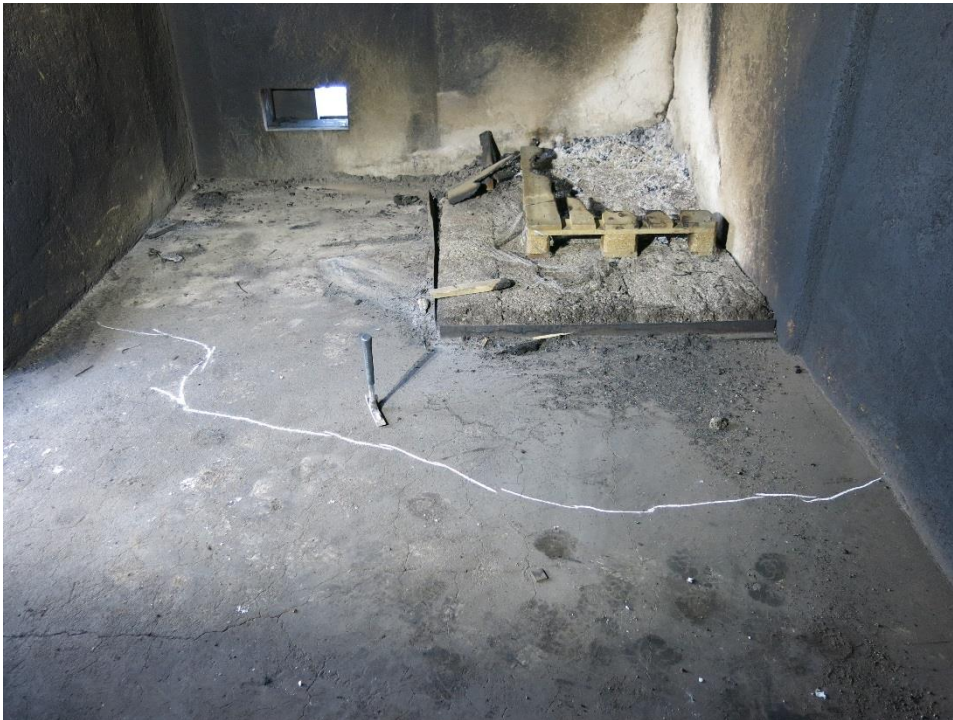
Bilde nr. 2 Delaminering.
