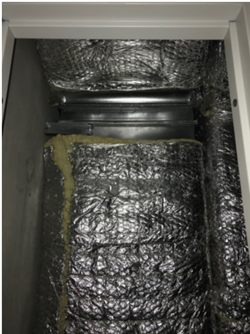
Bilde 3.6.2: Den uisolerte delen av kanalen viser overgang fra bend til vertikal kanal i sjakt, dette er grensesnittet mellom prosjektene.
