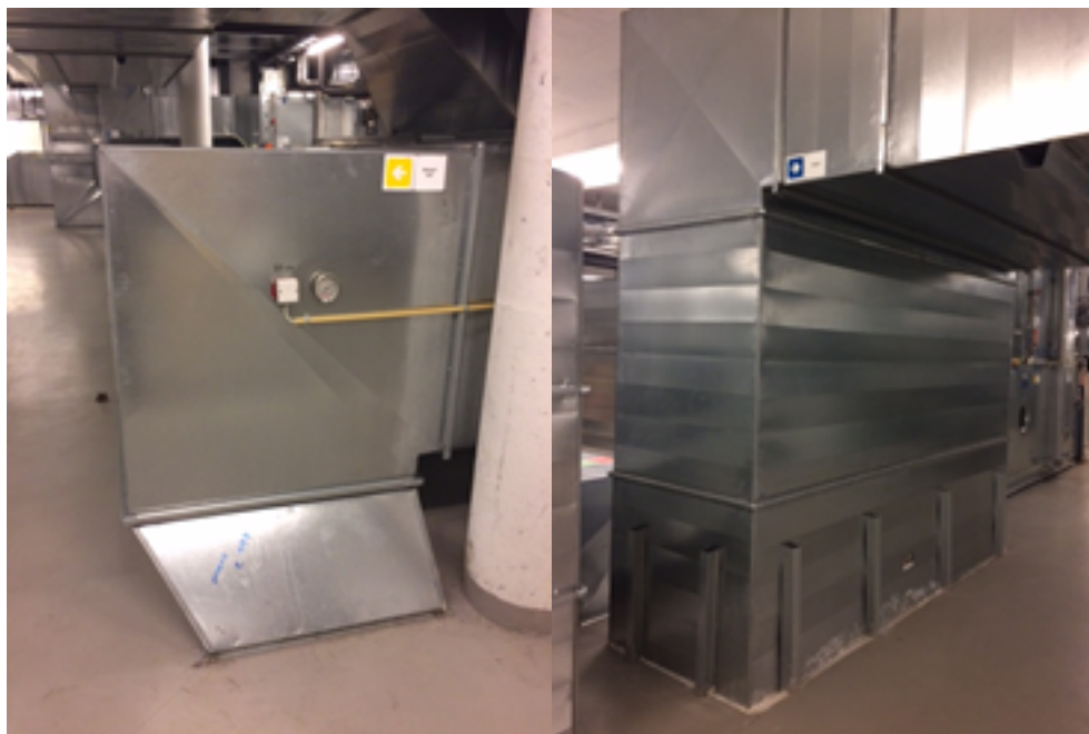
Bilde 3.6.0-4 og 3.6.0-5: Kanaler går i gulvet i ventilasjonsrommet i kjelleren.
