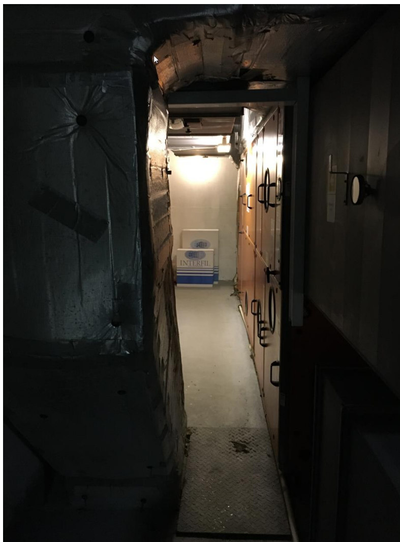
Bilde over – teknisk rom: Menergaggregat som betjener svømmehallen skal rives
