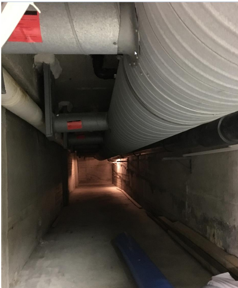
Bilde over - kulvert: side 2 Orienteringsbilde (tilluftskanal) Innerst til venstre: luke ut i bakken.
