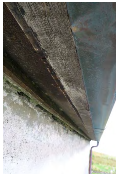
To langsgående bord under takutstikk samt list mot murveggen. Tjærebehandling er svært slitt.
