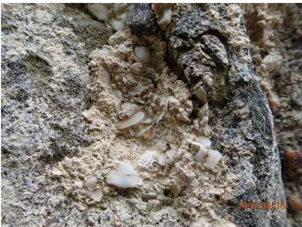
Eldre kalkmørtel med betydelig innslag av skjellsand.
