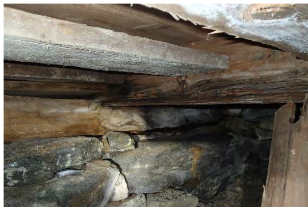
Hjørne NØ: Alvorlig råteskade i svill langs nordvegg (på murt fundament) samt tverrgående bjelke og i stubbloft.
