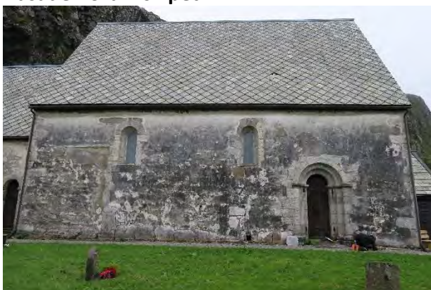
Nordveggen har mye pussavskalling og sort algevekst. Det meste av puss og kalkhvitning har falt av.
