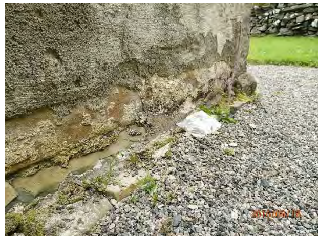
Kalkpussen fra 1985 har sluppet totalt mot underlaget i nedre del av vegg, mens rester av eldre kalkmørtel sitter fast.
