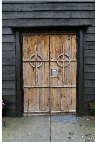
D4. Dør fra 1979 til våpenhus. Slitt overflatebehandling og en manglende bit i listdekor venstre sirkel.
