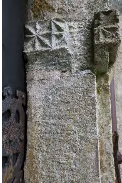
Høyre side av dørportal, brekkasje i uthugget middelalderdekor.
