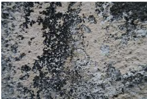
Toppstrøk av en varmt tonet kalkmørtel over en hvitere overflate, der algeveksten dominerer.
