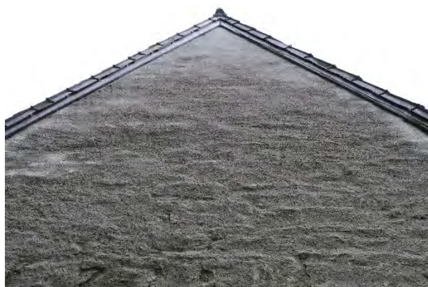
I øvre del av gavlfasaden er det bevart mer puss, men overflaten er nedbrutt og pussen har utilfredsstillende fasthet. Kalkhvittingen er falt av.
