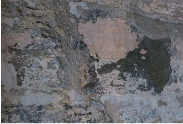
Rester av kalkhvitning og ulike typer mørtler på sørvegg under lektoriet.
