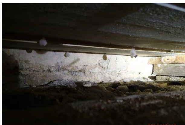
Bilde tatt inn over murkrona på tørrmurt fundament antatt 1912, mot yttervegg mot sør, med rester av kalkpuss. Edderkoppkokonger indikerer høyt fuktnivå.
