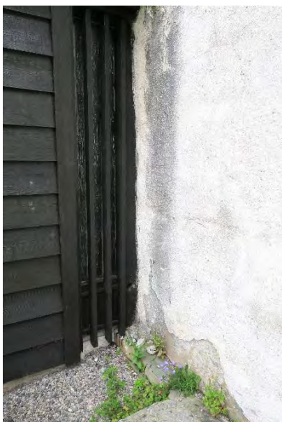
Misfarging på vegg / alger ved vannrenning fra våpenhusets tak.
