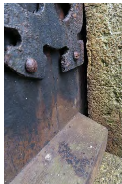
D2. Store glipper mellom dør og anslag begge sider, vann driver inn.
