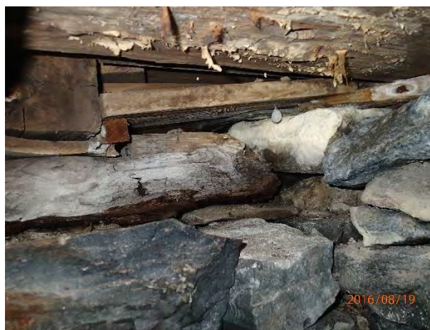
Detalj av råteskadd svill, jf. bildet t.v. Hvitt belegg på stein t.h. for enden av svilla.
