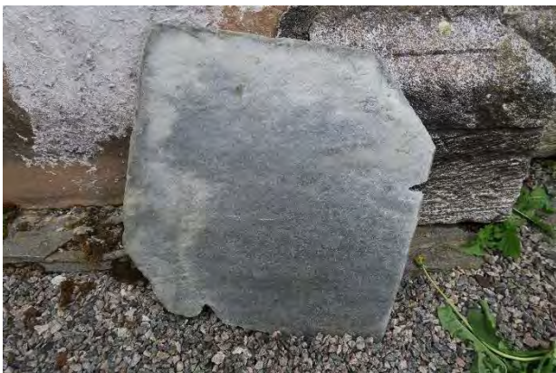
Den ene steinen som har løsnet er bevart på bakken. Vi ser tydelig at det ene hakket i steinen er utvidet/erodert etter bevegelse mot spikerfestet.
