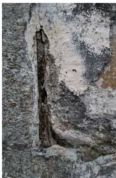
Detalj av bildet t.v.: nedbrutt mørtel og biter av rød tegl i fugen t.h. for kvadersteinen.
