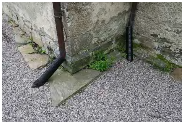
Plastrørene som danner overgang til dremsledningen, er lite pene. Samtidig begrenser et slikt lukket system muligheten for kontroll.
