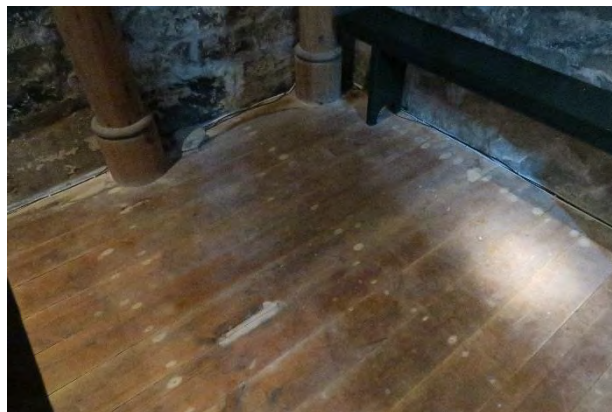
Under lektoriet hjørne NØ i skipet. Her er en mindre råteskade i overgulvet, med betydelig større omfang av råte i underliggende bjelker.
