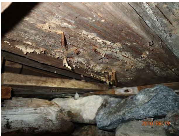
Hjørne NØ, rester av soppmycel på råteskadd stubbloftsboard.
