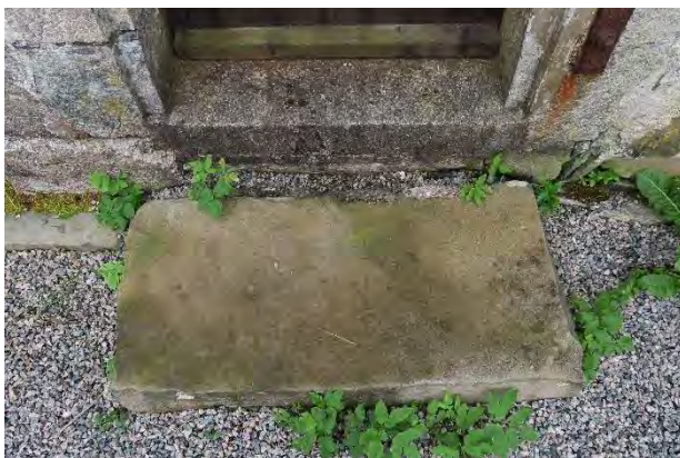
Helle foran D2 i korets nordvegg. Denne er litt utglidd og med vegetasjon mot muren. Støpt terskel i murveggen, god stand.
