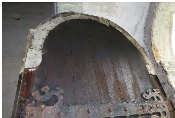
D2. Utettheten er søkt forbedret ved å spikre på remser av gulvbelegg i anslaget.
