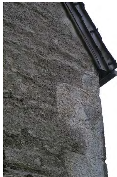
Detalj med kvaderstein av kleber og nedbrutt pussoverflate.
