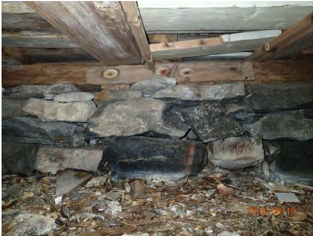
Tørrmurt fundament, antatt fra 1912. Merk kondensringer rundt alle spikrene.
