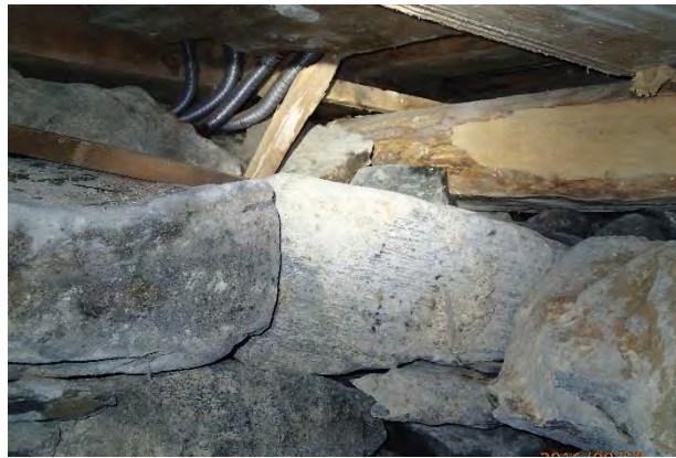
Under råteskaden på bildet t.v. Ingen synlige råteskader, men det kan være skader lengre ut over det murte fundamentet.
