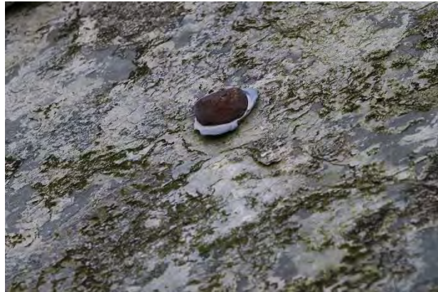
Detalj av sekundær innfesting, spiker med blytetting. Noe begroing/lav.
