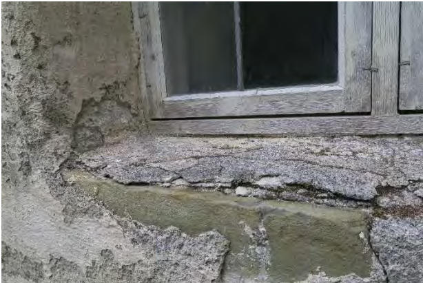
V4. Oppsmuldret puss og dårlig avrenning på sålbenk. Innpusset treramme.
