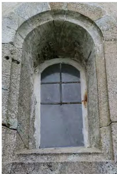
Vindu V2, kor N. Deler av blyspasseverk mangler.
