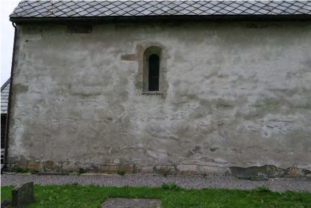
Vestre del av fasaden. Pussen sitter noe bedre enn mot nord, men den har falt helt av i nedre del, og er generelt slitt og med utilfredsstillende fasthet.
