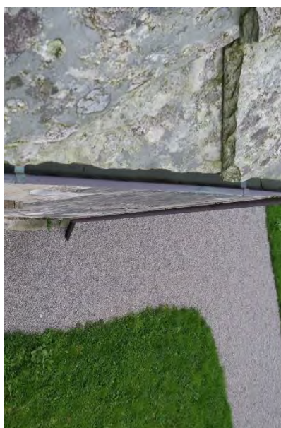
Takrenna er montert såpass langt inn under skifertekkingen, at det stedvis er svært knapp klaring for vannfallet ned i renna.
