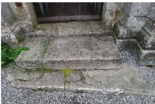
Trapp foran D1 mot nord. Utglidde trinn, sprekker og vegetasjon.
