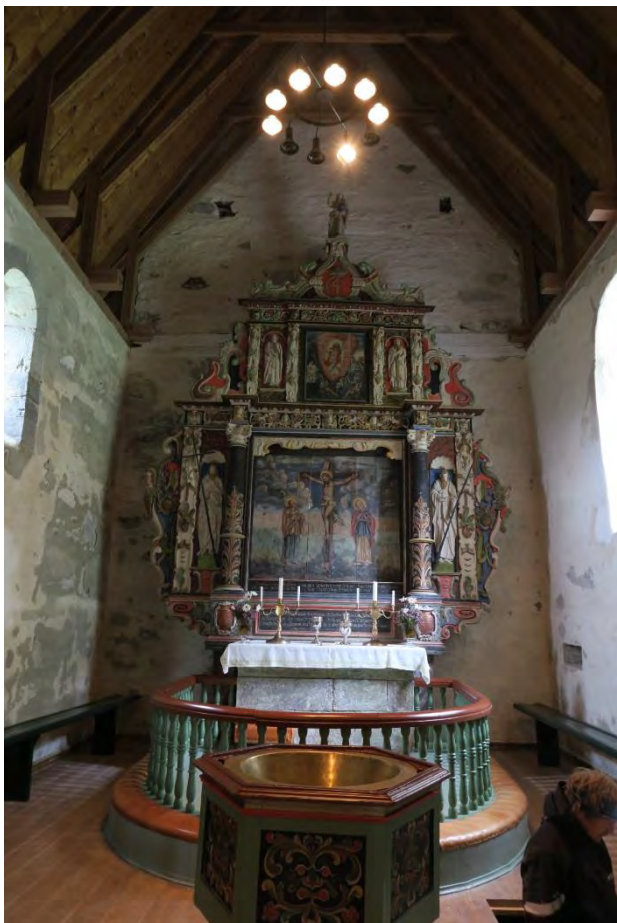
Mot øst. Merk forskjell i pussavskalling på nordveggen (t.v.) og sørveggen (t.h.)
