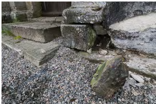
En mindre stein t.h. for den utglidde sokkelsteinen er løs (ligger foran i bildet). Ingen umiddelbar fare for videre utrasing.
