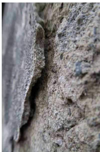
Detalj av bildet t.v. – tynne pussflak kan lett pirkes løs. Grovpuss løsner fra grunning.
