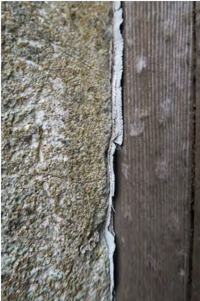
D2. Detalj av provisorisk tetting i anslaget mellom dørblad og stein i smyget.
