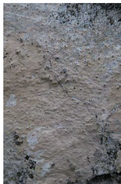
Detalj av overflate med gulaktig kalkhvitning, enkelte riss og sort algevekst.
