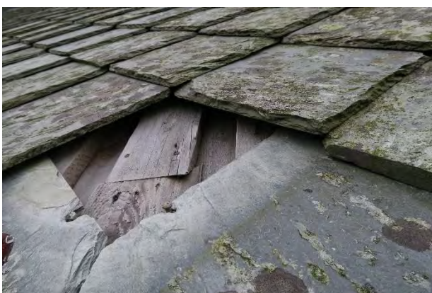
Avdekket bordtak under en manglende helle mot nord.
