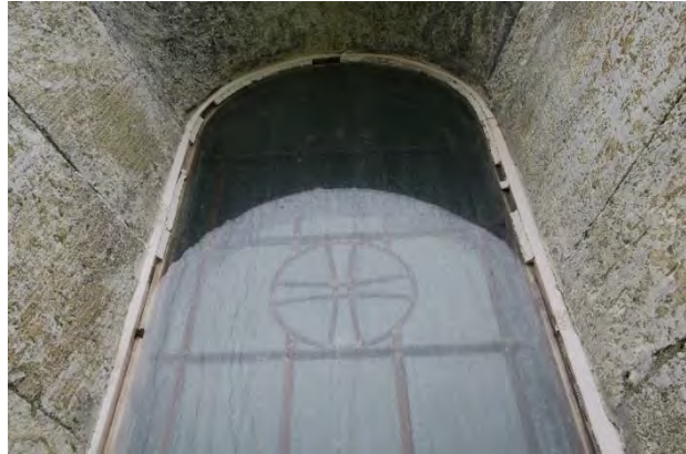
V1, skip N. Omfattende kittutfall rundt utvendig glass.
