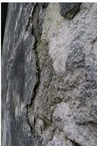
Pussen fra 1985 faller av i store flak. Dårlig heft til underlaget, og mye pussmørtel uten tilfredsstillende fasthet.
