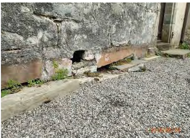
Kor mot N. Utglidd og skjevsatt sokkelstein langs skipets nordvegg.
