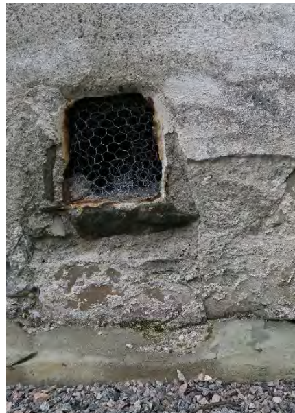
Rester av rusten jernramme til ventilasjonssjakt, bak ny puss sitter rester av eldre kalkmørtel.
