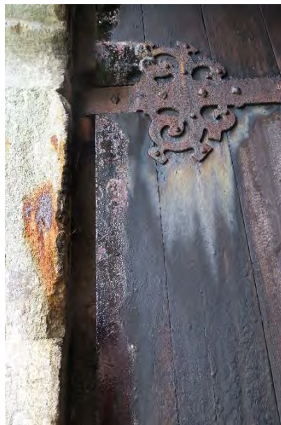
D1. Dekorative beslag fra 1912 er svært rustne, primært i overflata.
