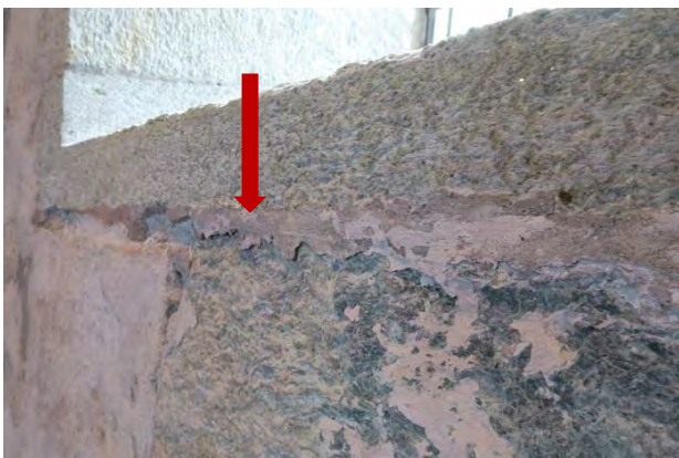
Rester av kalkbasert slemming (grålig) henger som frynsete flak oppunder vindussmyget.
