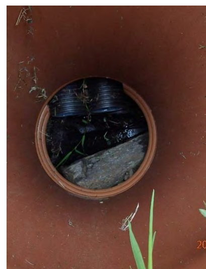
Drensrør i kum mot sør.
