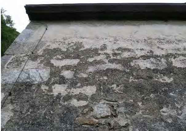
Øvre del av veggen, der noe av pussen sitter, men både kalkhvitting og pussen har tegn til forvitring.
