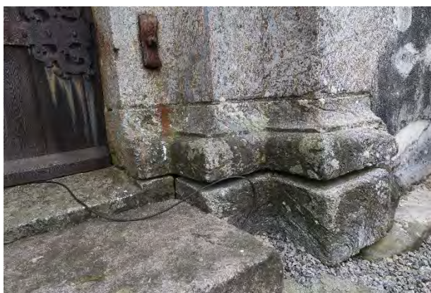
Jf. bildet t.v. Stor glippe over den store sokkelsteinen. Det er kontakt/kraftoverføring i bakkant av steinen.
