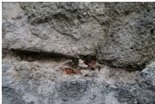
Enkelte steder er det brukt rød tegl til pinning i fugene. Senere reparasjon.
