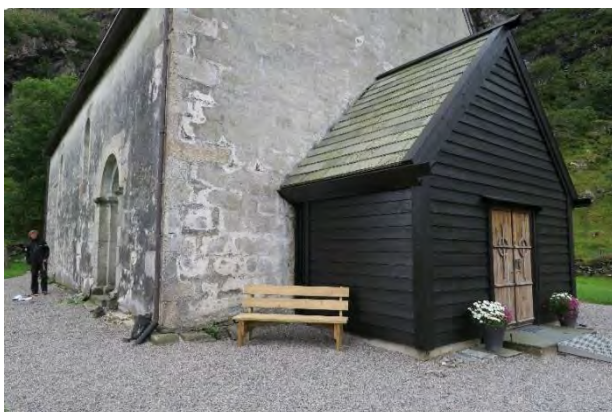
Kalkhvittingen har falt av og pussen forvitrer, mest nedfall mot hjørnene.
