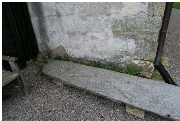
På nedre del av veggen har pussen falt helt av.
