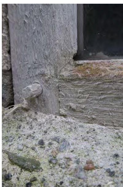
V3, detalj av vindu med tapper på vei ut. Avskallet maling og vært nedbrutt treoverflate, hvit oppflising kan minne om treverk påvirket av kjemisk nedbrytning (salt).
