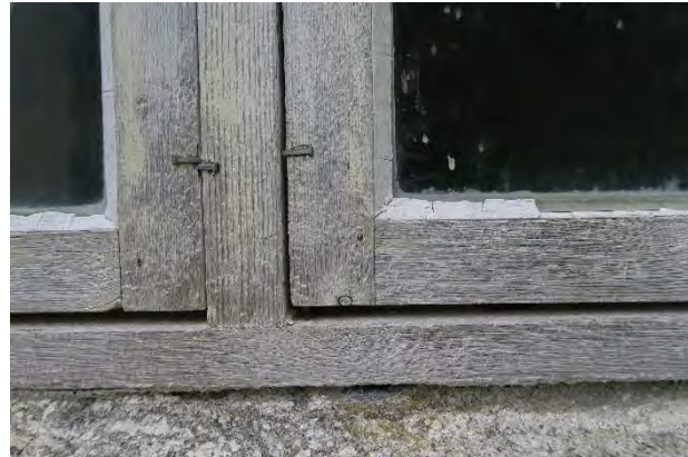
V4. Treoverflaten er sterkt grånet og malingen skallet av. Kitt er uttørket og faller ut.
