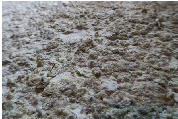
Detalj av bildet t.v., der fukt har ført til forvitring av steinoverflata – småstein ligger løse på overflata. Liten konsekvens.
