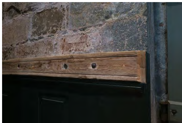
Plank av ubehandlet tre over brystning, alderdommelig profil, gjenbruk av bjelke under tidligere himling. Fuktnivået i denne delen av planken mot nordvest (ved dør) er svært høy, likevel er det ikke påvist råte. Salter antas å stamme fra soppveksten.
