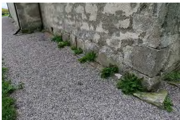
Korets sørvegg, utglidd sokkelstein med uheldig fall mot muren, t.h. hjørne SØ.
