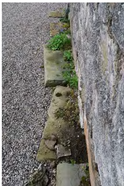
Utglidd sokkelstein ved korets nordvegg. Jord i murverket.
