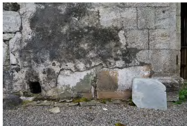
Lufteventil til krypkjeller og en del stein satt på høykant i murens nedre del. (T.h. nedfalt takskifer.)
