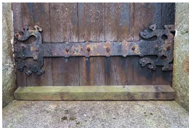
Beslagene har omfattende overflaterust.
