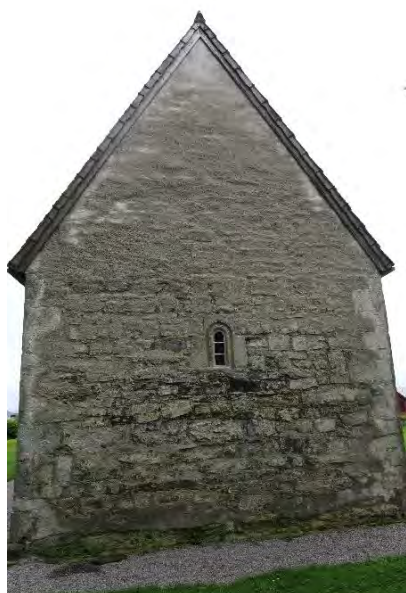
Fasade øst, antatt med opprinnelig murverk og vindusåpning fra ca. 1150. Pussen er svært nedbrutt.
