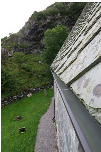
Takrenna er montert relativt godt innunder takutstikket, slik at det enkelte steder er kun 2 cm fra skiferhellens dryppkant til takrennas ytterkant (innside).
