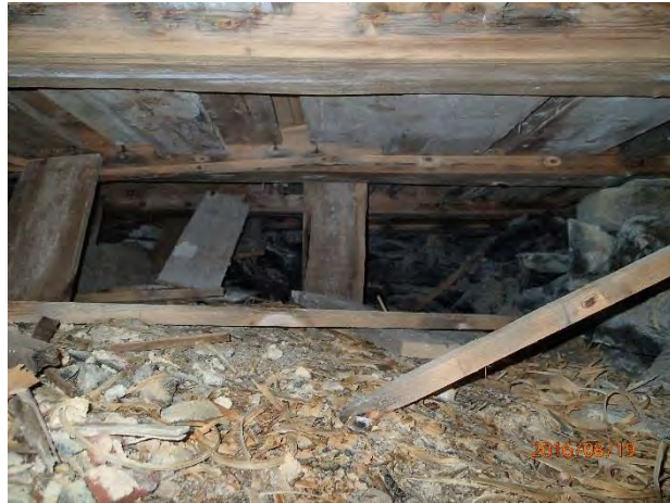
Generelt mye nedfall av stubbloftsbord grunnet rustne spiker.
