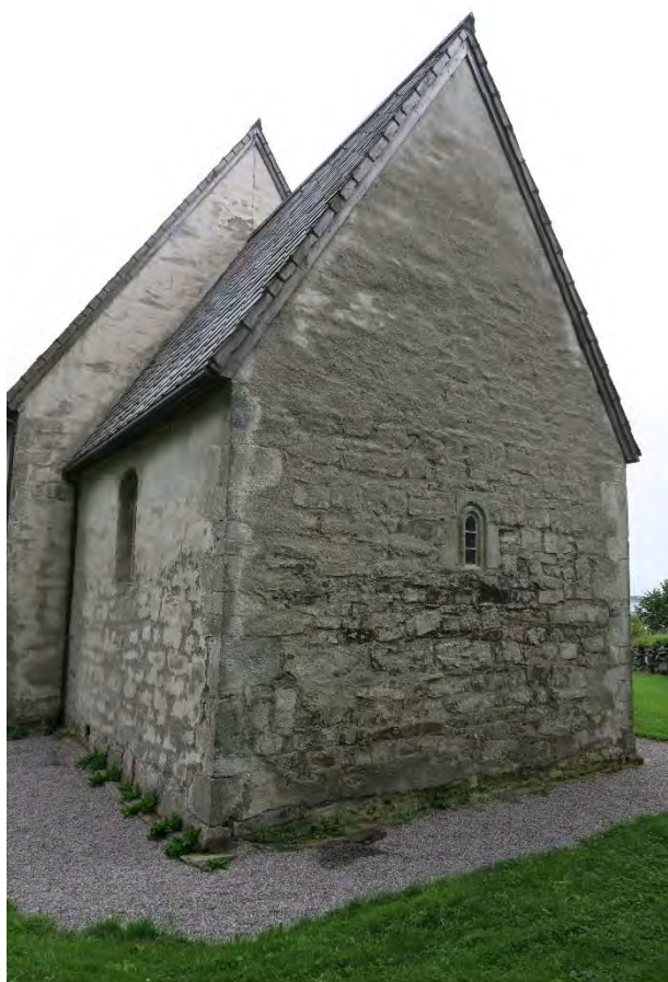
Koret, gavl mot øst. Her er en opprinnelig vindusåpning, men trerammen antas å være fra 1912.
