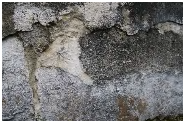
Typisk veggflate der lag av nedbrutt kalkmørtel har løst i ulik grad.
