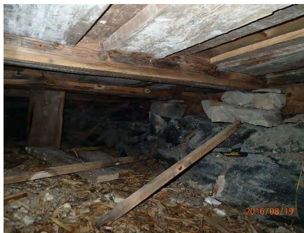
Eksempel på råteutvikling i tverrgående bjelke, fukten ser ut til å være konsentrert rundt de rustne spikerne, der fuktig luft kondenserer mot metallet.
