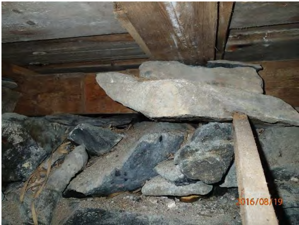
Oppmurte fundamenter under bjelkelaget samt hvitt belegg på treverk, muligens (mugg)sopp.
