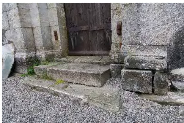
Sokkelstein ved dør har setninger og er glidd ut av posisjon. Årsak ikke endelig kartlagt, muligens senere gravearbeid/ledningsføring (1974).
