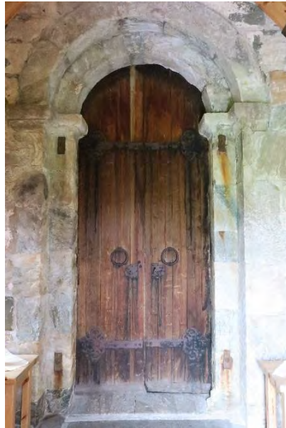
D3. Dør inn til skipet fra våpenhuset. Tidligere ytterdør. Slitt overflatebehandling og rustne beslag. Liten konsekvens innendørs.
