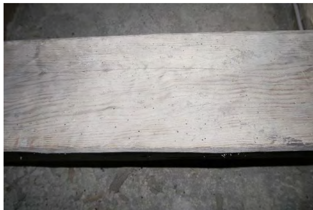
Flyvehull etter mott (stripet borebille) i deler av takkonstruksjonen. Liten konsekvens.
