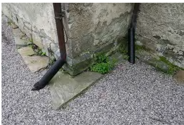
Overgang skip/kor mot S, utglidd sokkelstein, dels løst fra / utenfor murkonstruksjonen. Plastrørene mellom nedløpsrør og drensledning er skjemmende.
