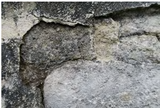
To tynne lag med kalkpuss (fra 1985) som ikke har tilfredsstillende fasthet, og som løsner lag for lag.
