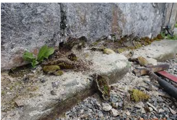
Skip fasade N. Mye vegetasjon over sokkelsteinen.
