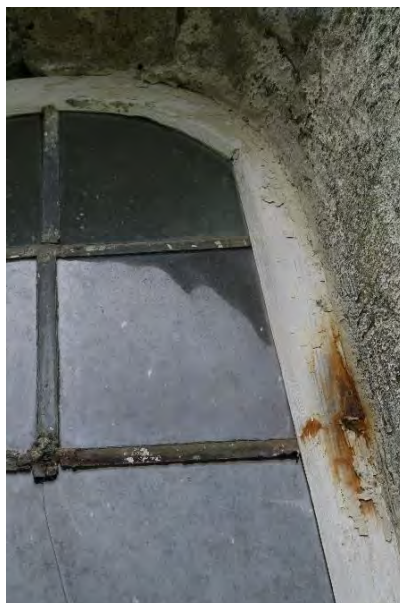
V2. Rester av gulhvit maling på rammen. Omfattende rustutslag ved innfesting i mur.
