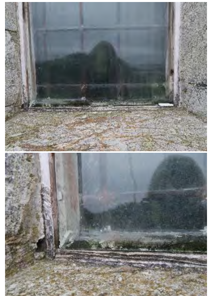
V1, skip N. Detaljer av treramme med mørtelreparasjoner. Fare for skjulte råteskader i fals mot stein.
