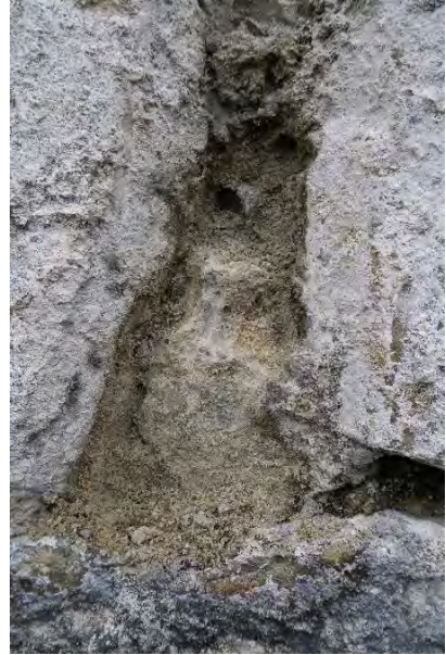
Mørtelen et stykke inn i fugene er fuktig og sandete/oppløst.
