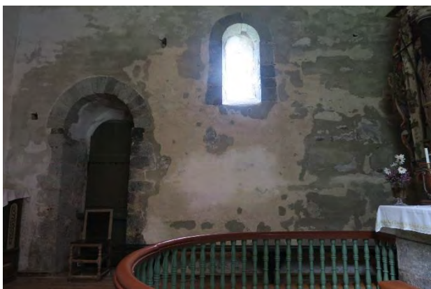
Nordveggen med betydelig avskalling av siste lag med kalkslemming (grå, ikke tilfredsstillende fasthet). De grå flakene ligger utenpå den eldre kalkhvittingen, med dertil dårlig vedheft.
