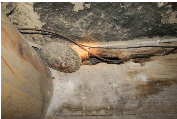
Detalj av bildet t.v., råteskade i ett bord langs nordvegg samt større spor etter vannrenning. Underliggende råteskade, se bildene under.
