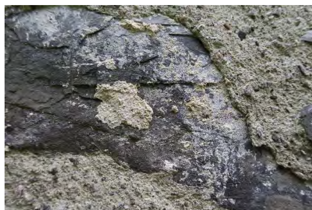
Flekker med eldre, fast kalkmørtel (hvitere), og den grålige kalkmørtelen fra 1985 (t.h.), som løsner i flak.
