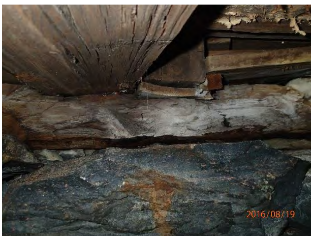
Hjørne NØ: Svill langs yttervegg har alvorlige råteskader og deformasjon. Oppe t.v. ses råteskadet underside av tverrgående bjelke.
