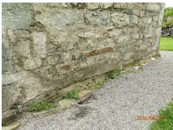
Kor mot Ø. Uryddig sokkelstein og vegetasjon, uheldig fall inn mot muren.
