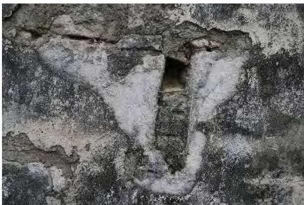
Åpent hull i fuge med utfall av mørtel og pinningstein.
