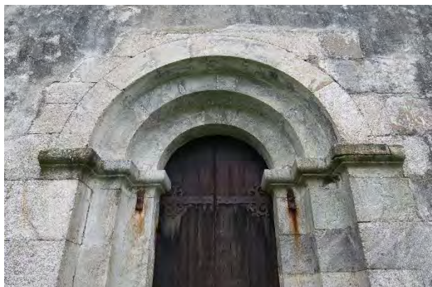
Klebersteinsbuer over dørportal. Rust fra eldre jernfester i muren.
