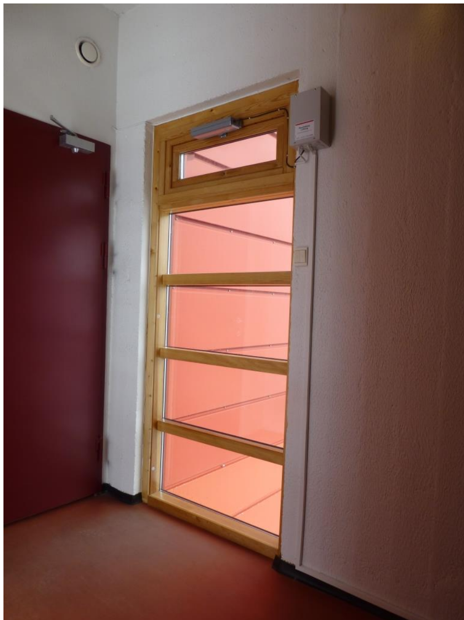
Bilde 20 Vindu i trapperom – Dette med røykluke.
