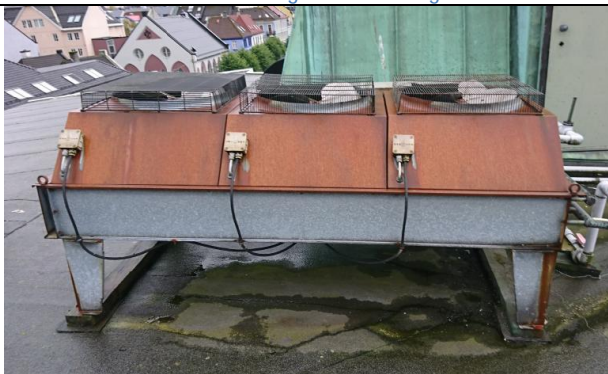
111 Kjølemaskin på tak
