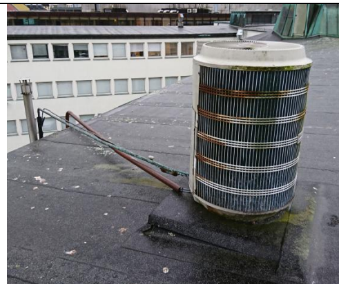
112 Kjølemaskin på tak
