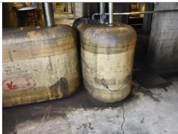
Bilde 29: Oljeforurensning (lavforurensning) i betong
