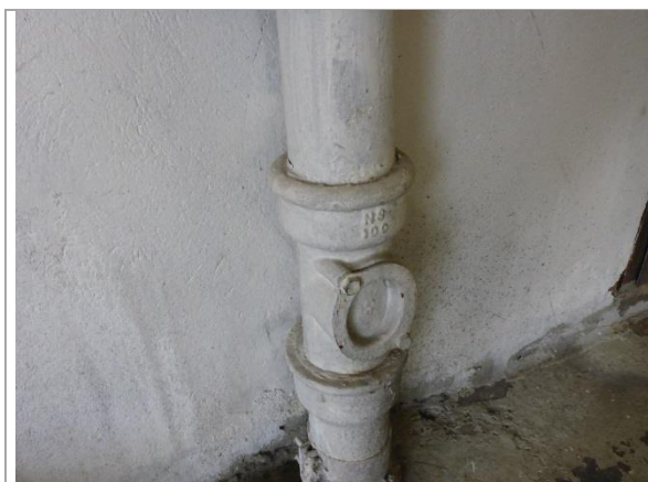
Bilde 23: Soilrør med blyskjøter
