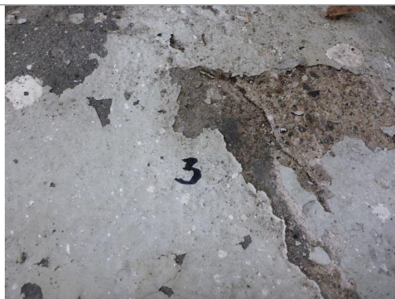
Bilde 4: Epoxybelegg i bussgarasje, lavforurenset av PCB.
