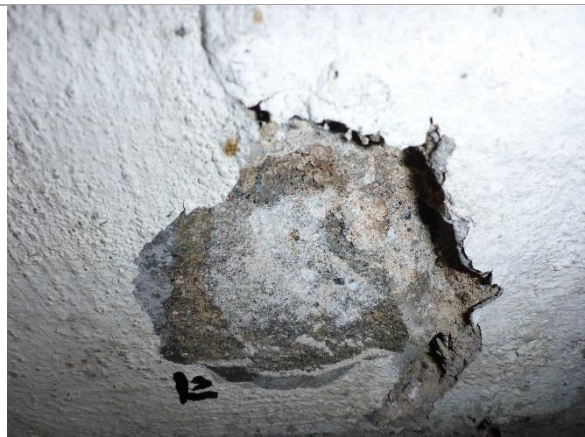
Bilde 12: Murpuss på verkstedvegg, lavforurensset av PCB.
