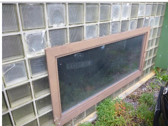
Bilde 18: Isolerglass i glassteinsvegg
