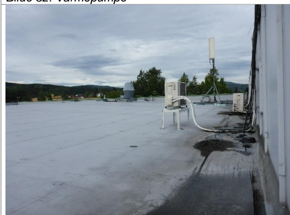
Bilde 34: Varmepumpe, utedel
