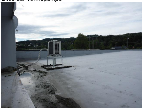
Bilde 35: Varmepumpe, utedel
