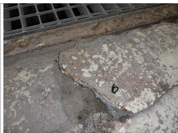
Bilde 7: Betonggulv i bussgarasje, lavforurenset av PCB
