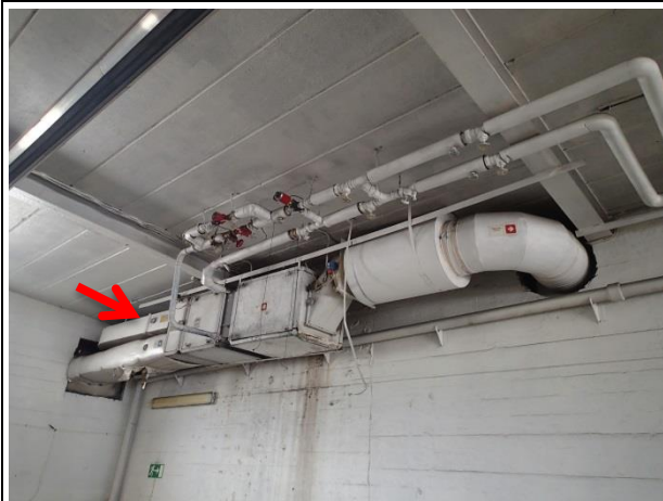
Ventilasjonsaggregat høyt opp på himlingen i rom 17. Uklart hvor mange målere det er på aggregatet.
