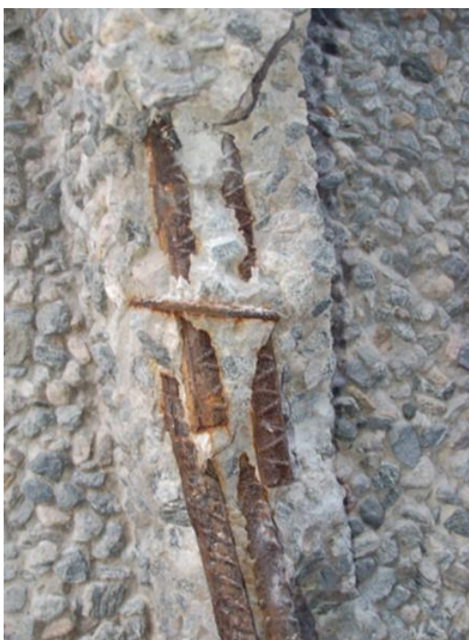
Bilde 4 Bildet viser korrosjon på vertikal søylearmering i en skjøt ved etasjeskille. Legg merke til at jernene fra etasjen under blir bøyet inn og at omfaringsjernene videre opp i søylen i etasjen over ligger blottlagt. Ettersom trykkarmeringen ender i løse luften vil ikke denne armeringen overføre krefter/spenninger videre ned i underliggende søyle. Lastoverføring fra armering til betong og videre til armeringen under vil måtte starte høyere oppe. Dette vil i teorien svekke søylens kapasitet.
