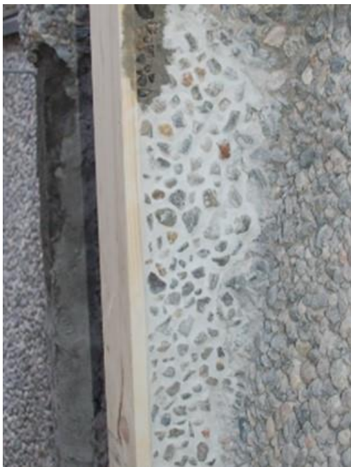
Bilde 10 Bildet viser at den første reparasjonene som ble utført. En ser at det ble lagt inn for lite stein og med for stor avstand. En ser også at steinene ikke må trykkes så langt inn i mørtelen. En ser også at det ble valgt en for lys mørtel for denne prøvereparasjonen.
