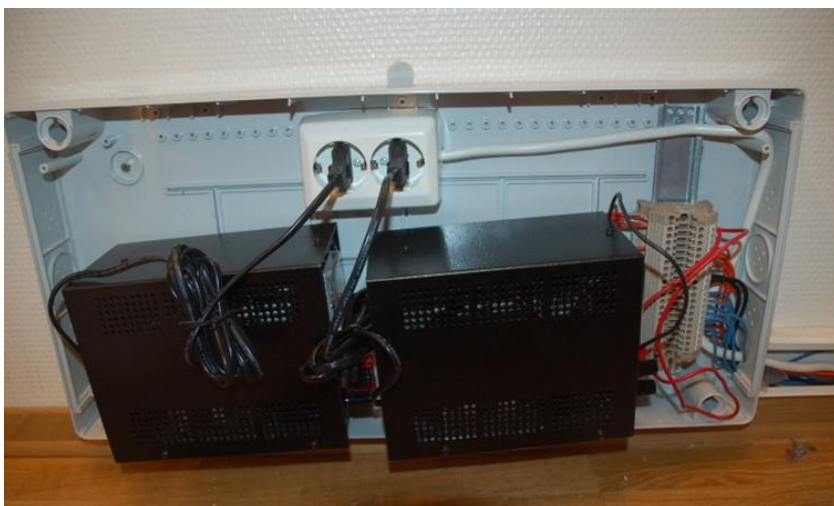
Bilde 19 Skap inne på kontor i 3 etasje. På kablene mellom øikeretter og de 4 anodekablene montert vi inn 100Ohm motstander slik at enkanmåle spenningsfallet over disse og derved kunne regne ut strømgjennomgangen til hver anodesone. I dette skapet kan en utføre de nødvendige kontrollmålinger for anodesonene. En kan måle- og justere spenning til anodesonene. En kan måle strømgjennomgangen til hver anodesone. En kan måle motstand og ledningsevne mellom anode og armering En kan måle potensialforskjellen mellom referanseselle og armering. En kan derved måle endring i potensiale på stålet når det setter på likestrøm mellom anode og armering. En kan måle potensialendringer IR-drop og depolarisering ved å tenne og slukke for strømmen på likeretterne.
