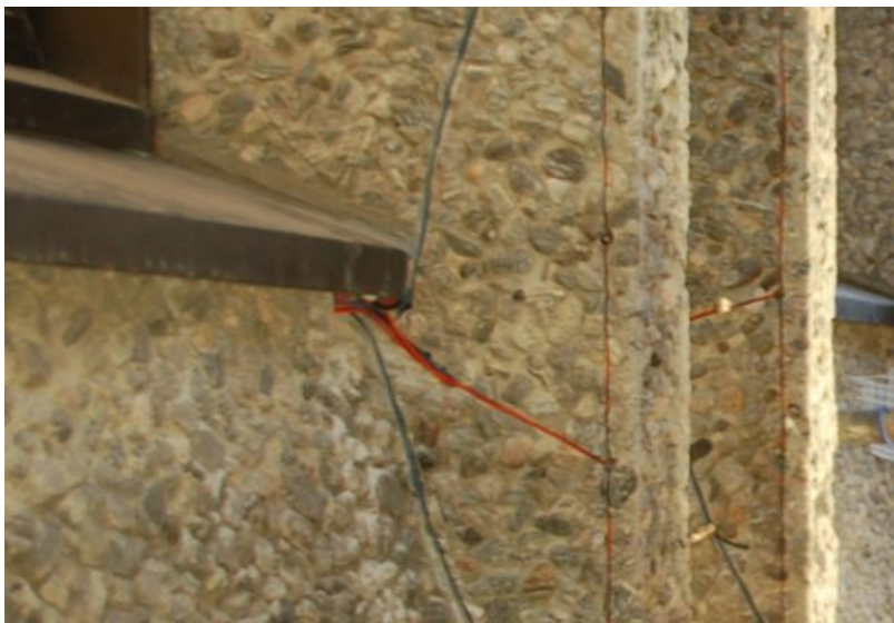
Bilde 16 Kableføring. Kabler ble lagt i trekkør under vindusbeslag. Forbi søyler ble det boret huller gjennom søylene, like under beslaget, slik at kablene kunne tres gjennom. For kableføring inn i bygget, ble det boret hull gjennom brystning, like under vindusbeslaget. Hullet kommet da ut på innsiden, bak vindtetting og isolasjon. Det må her legges trekkerør og så må det tettes rundt vindspærre på innsiden.
