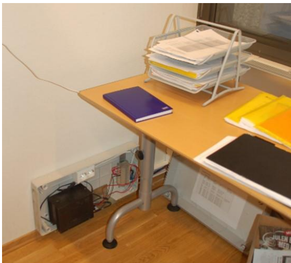
Bilde 18 Innvendige kabler og koblingsboks. Kabelene kom inn i kasse under vinduet. Kabelene ble så lagt ned mot gulvet og ut på vegg. Det ble montert et koblingsskap med innlagt 230 volt og plass til 2 stk sorte likerettere, samt rekkeklemme for armeringsforbindelser, 8 referanseller og 4 anodeforbindelser.
