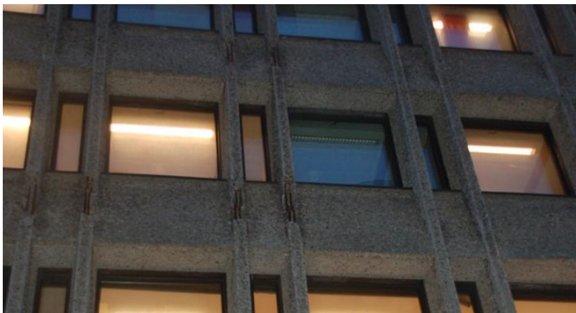
Bilde 5 Bildet viser synlig skader på fasade sør. Skadeomfanget har øket mye mellom 2012 og 2015.
