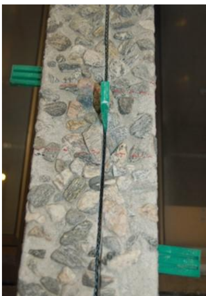
Bilde 11 Viser sagtann anode innlagt i skårede spor i forkant og på hver side av søyle. Det brukes små kiler for å holde sagtann anoden på plass inne i sporet.
