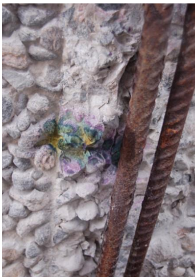
Bilde 6 Bildet viser frilagt søylearmering. Før rengjøring av armering. Manglende bøyer
