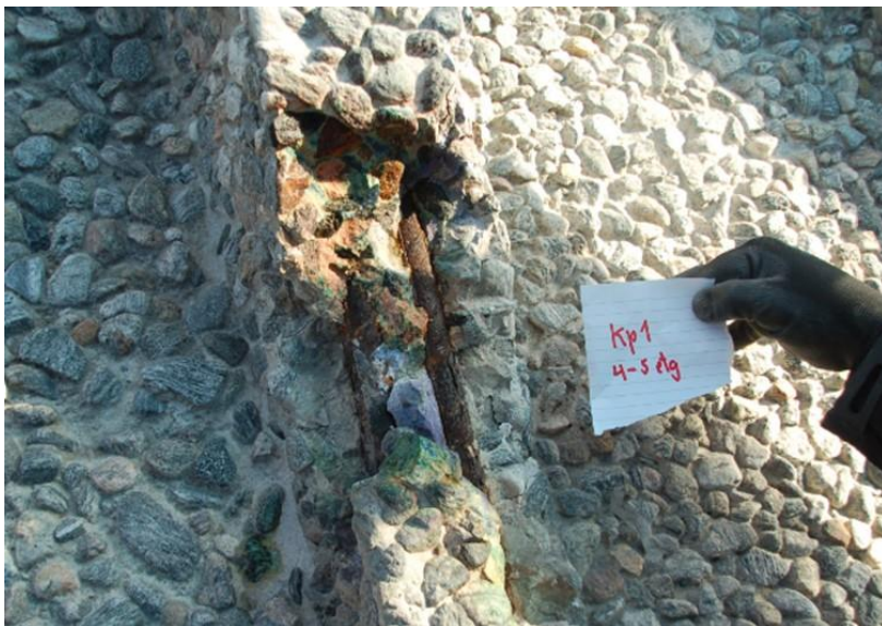
Bilde 3 Bildet viser en typisk skade der løs betong er fjernet. En ser at armeringen har korrodert lenge og det er generert store sprekker og riss som gjør at større betongstykker var i ferd med å løsne fra fasaden og falle ned.
