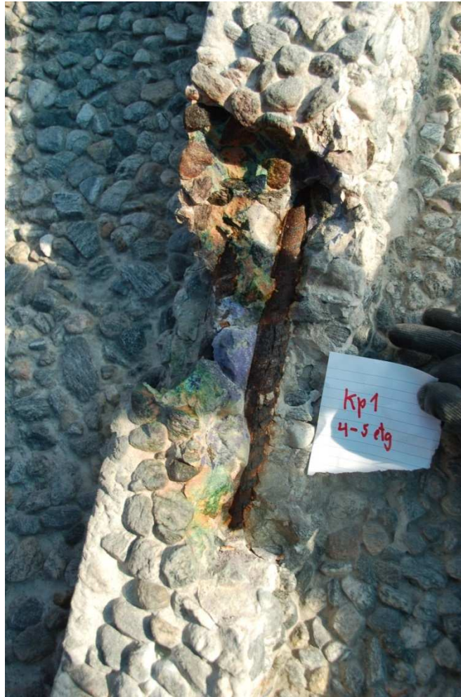
Foto 2: Eksempel på skadet søyle.
