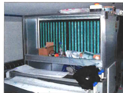
Ventilasjonsaggregat må forsegles for å hindre støvinntrænging
